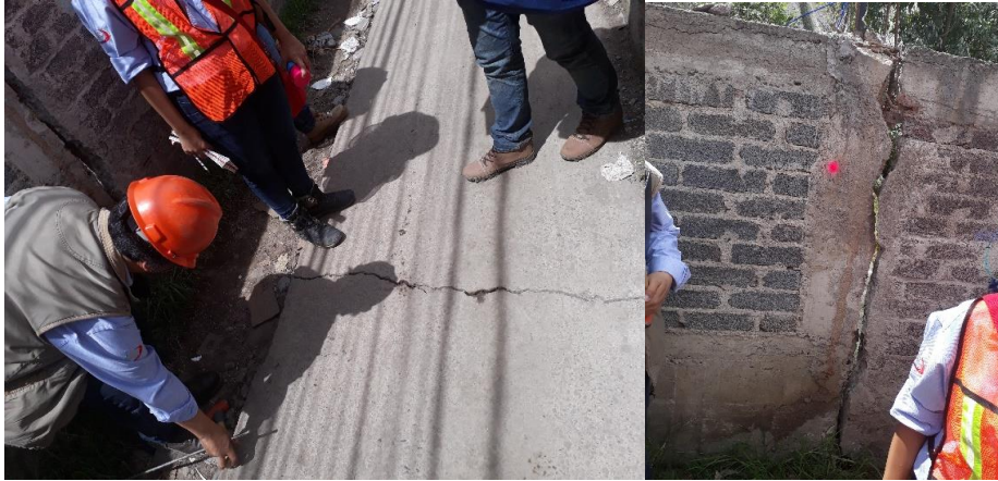
Figura # 3.2. Patron de fracturamiento en casa habitación asociado al sistema de fracturamiento principal NE 75 a 85° SW.
