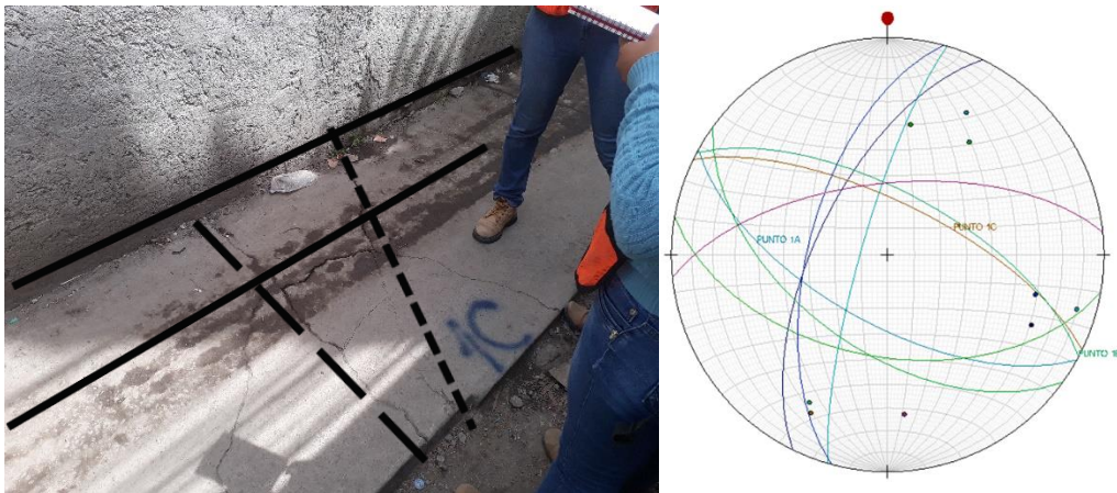
Figura # 3.3. Patron convergente de fracturamiento en concreto de callejones del Barrio de San Gregorio. Se muestran los dos sistemas generales de fracturamiento dominantes A y B en línea
