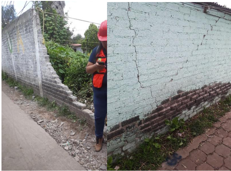
Figura # 3.4. Bardas de casas habitación del Barrio de San Gregorio mostrando los efectos de la familia de fracturas generales del sistema B.
