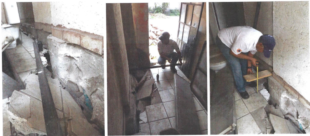
Figura 13 Daños registrados en las instalaciones del hotel ExHacienda de Xaltocan, debidas al hundimiento súbito sucedido durante el evento telúrico del 19 de septiembre de 2017
