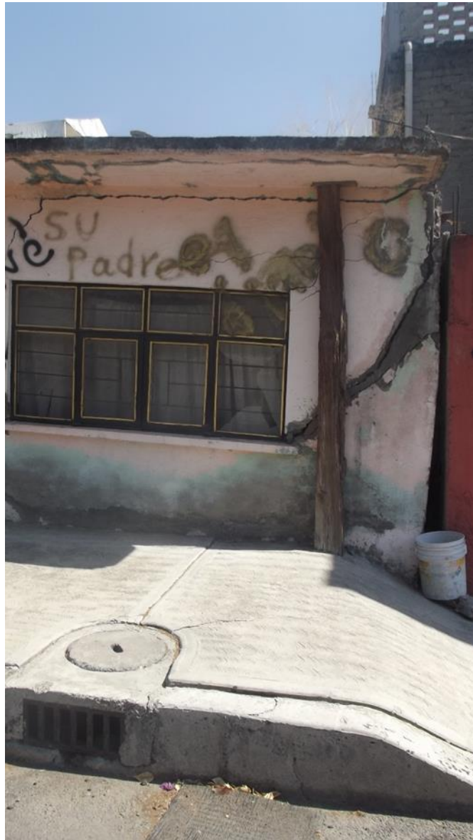
Figura 6. Fotografía que muestra las afectaciones en la vivienda. Los daños son importantes debido al asentamiento diferencial producido y que se evidencia con la fractura diagonal a 45° que comienza en el castillo de confinamiento y concluye en la ventana donde se observa que no tiene confinamiento. La falta de cadena de cierre permitió que la losa se separara de los muros teniendo la necesidad de apuntalar provisionalmente parte de la construcción (19.2897° N; 99.0624° W. Calle: Pez Vela).
