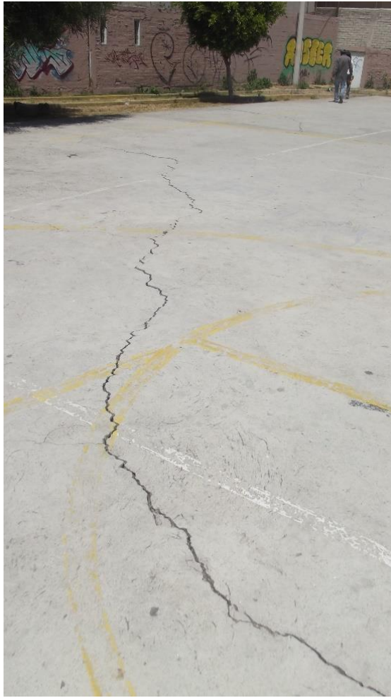
Figura 9. Fotografía que muestra los daños en la cancha deportiva; no presenta desplazamiento vertical (19. 2919° N; 99.0612° W. Calle: Pez Cardenal).
