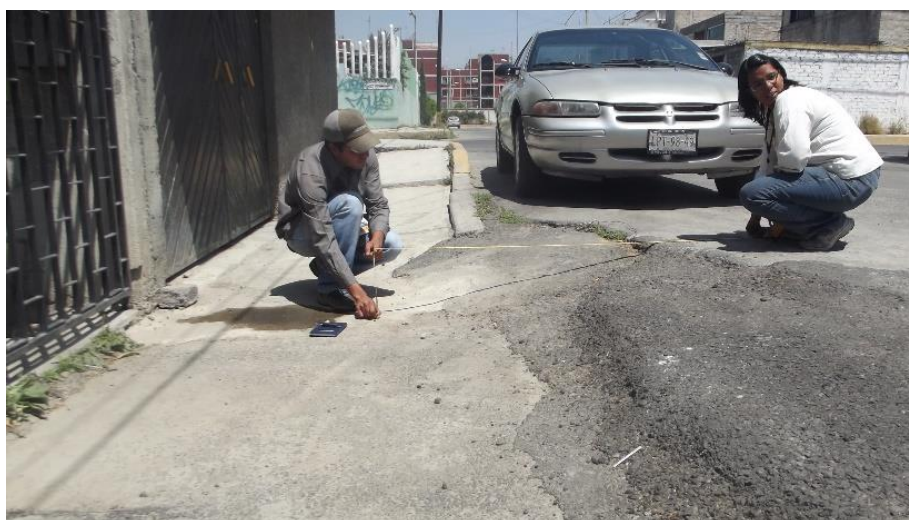
Figura 8. Fotografía que muestra la manifestación de la estructura de hundimiento en el pavimento, donde el desplazamiento vertical es de 30 cm (19. 2914° N; 99.0614° W. Calle: Pez Gurami).
