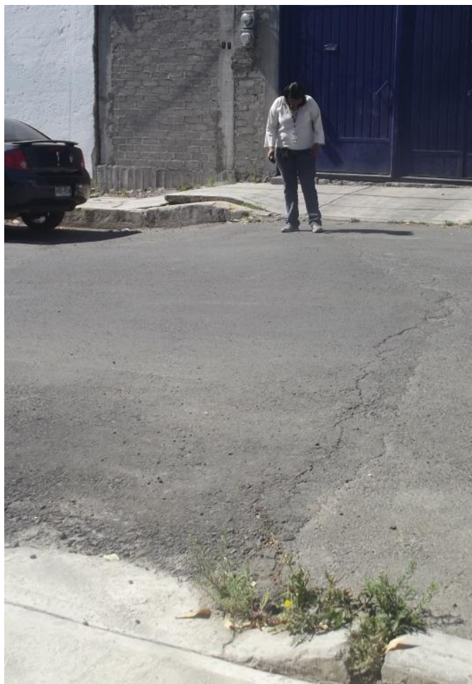
Figura 5. Fotografía que ilustra la zona de hundimiento con un desplazamiento vertical de 38 cm. Al fondo se observa la acera deformada y la vivienda con daño en sus muros (19.2896° N; 99.0623° W. Calle: Pez Vela).
