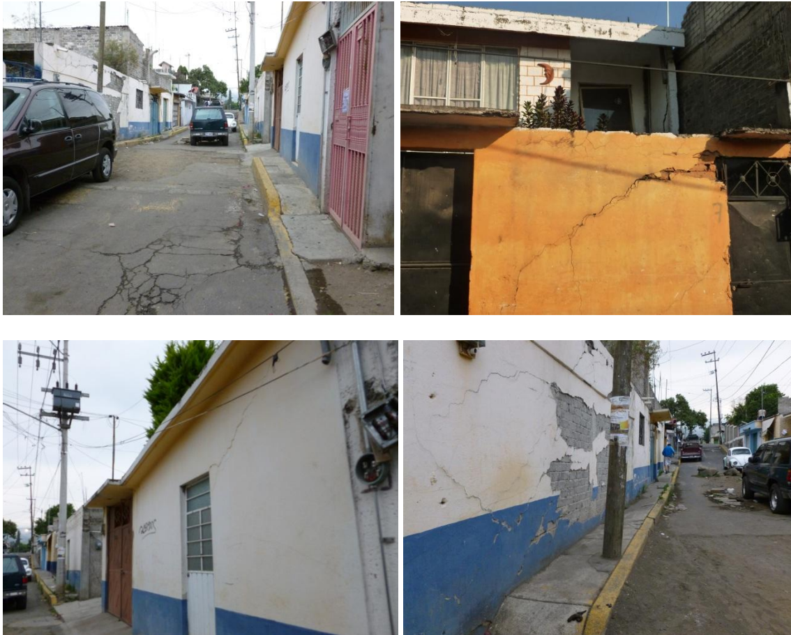
Fotografía 1. En la parte superior izquierda se observa fracturamiento de las vialidades asociadas a hundimientos regionales, en la parte superior e inferior derecha fracturas ocasionadas por asentamientos diferenciales. En la parte inferior izquierda, se observa una fractura por asentamientos diferenciales y falta de confinamiento.
