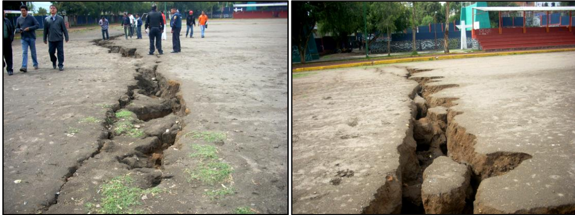
Fotografía 24 y 25. Imágenes proporcionadas por Protección Civil delegacional, donde se muestra la evidencia de la grieta en el mes de Agosto del 2011.
