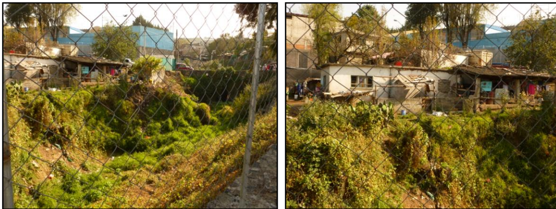
Fotografía 32 y 33. Vivienda afectada por erosión hídrica
