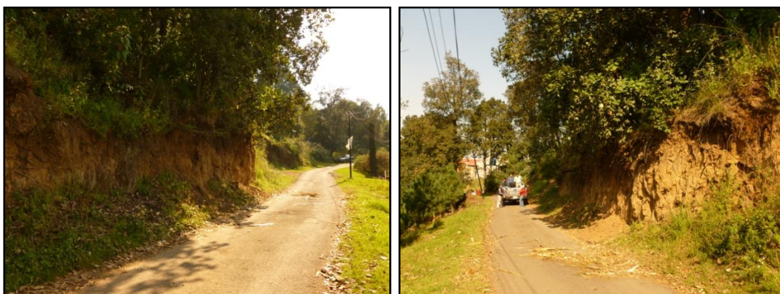
Fotografía 2 y 3. Inestabilidad de talud en un camino del poblado San Salvador Cuauhtenco
