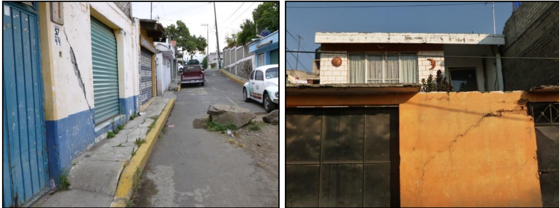
Fotografía 22 y 23. Viviendas con presencia de fracturas en los muros, evidencia de fenómeno.
