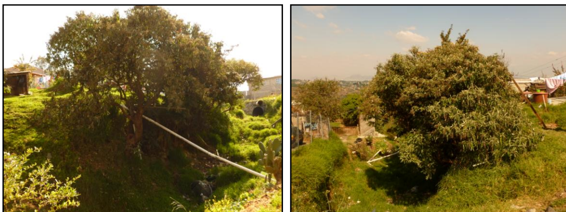
Fotografía 30 y 31. Peligro por erosión hídrica
