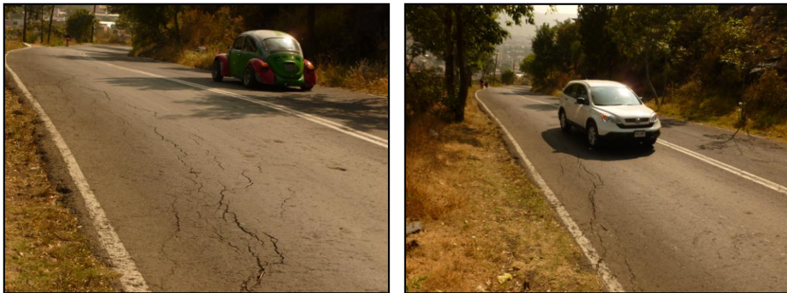
Fotografía 26 y 27. Susceptibilidad por hundimiento en el tramo carretero
