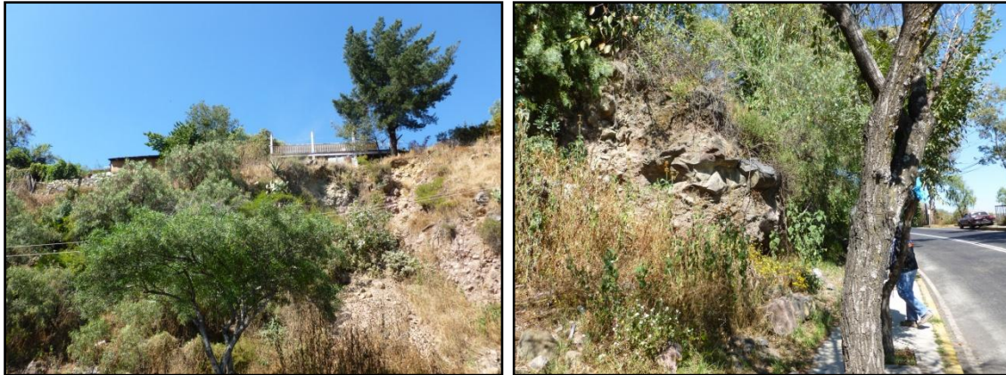
Fotografía 12 y 13. Peligro por caída de roca en la carretera que comunica a la cabecera delegacional Villa Milpa Alta.
