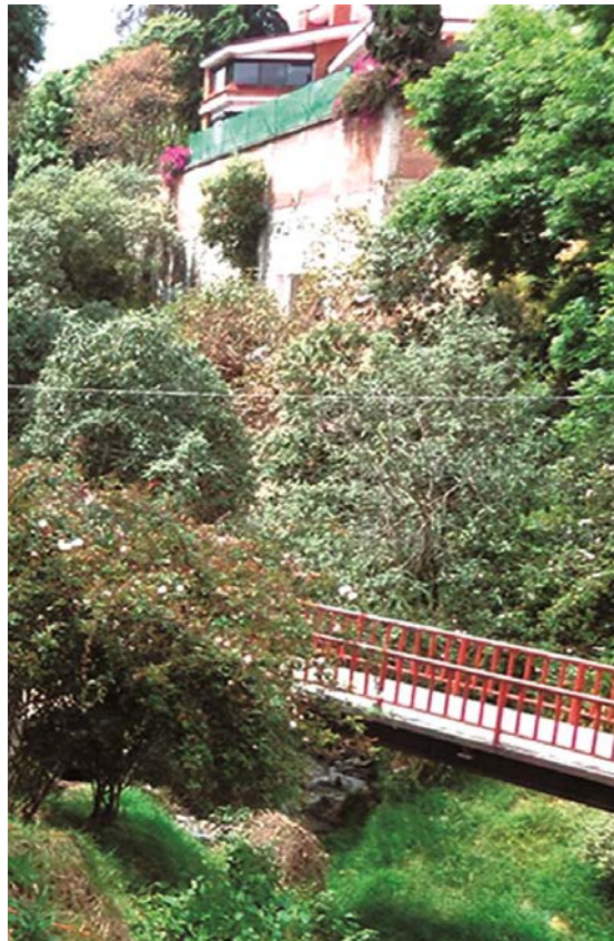
Figura 6. Construcción ubicada al borde de un canal natural protegido con un muro de contención de ladrillos; se observa un puente con una ligera inclinación, lo que denota la pérdida de material en un extremo de este a causa del paso del agua ( 19.3161^{\circ} N, 99.2531^{\circ} W. Calle: sin nombre oficial, colonia Atacaxco).
