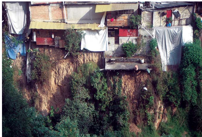
Figura 22. En la fotografía se observa un conjunto de edificaciones de mampostería, que presentan daño estructural, desplantadas sobre las capas 1 y 2 que afloran en la pared de la barranca ( 19.3162^\circ \text{N} , 99.2538^\circ \text{W} . Calle: Sin nombre oficial, colonia Atacaxco).
