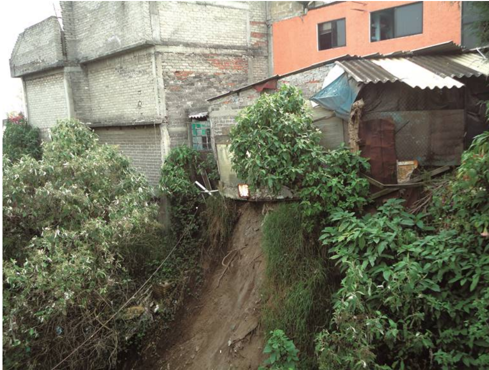
Figura 8. Se observan viviendas desplantadas al borde de una barranca, al pie de la vivienda del lado derecho se presenta arrastre de material a causa del intemperismo notable en la falta de vegetación y las raíces de los árboles expuestas (19.3161° N, 99.2527° W: Calle: Sin nombre oficial, colonia Atacaxco).
