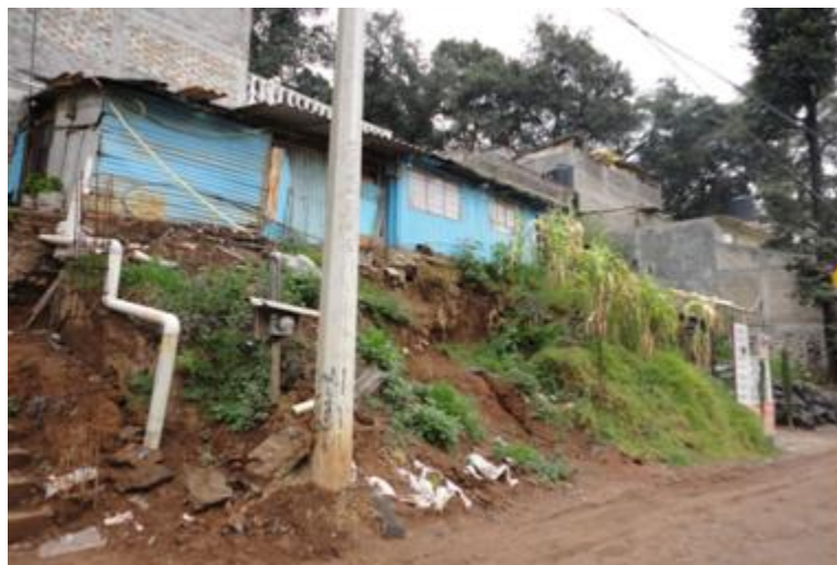
Vivienda de autoconstrucción establecida sobre una masa de suelo sujeto a erosión.
