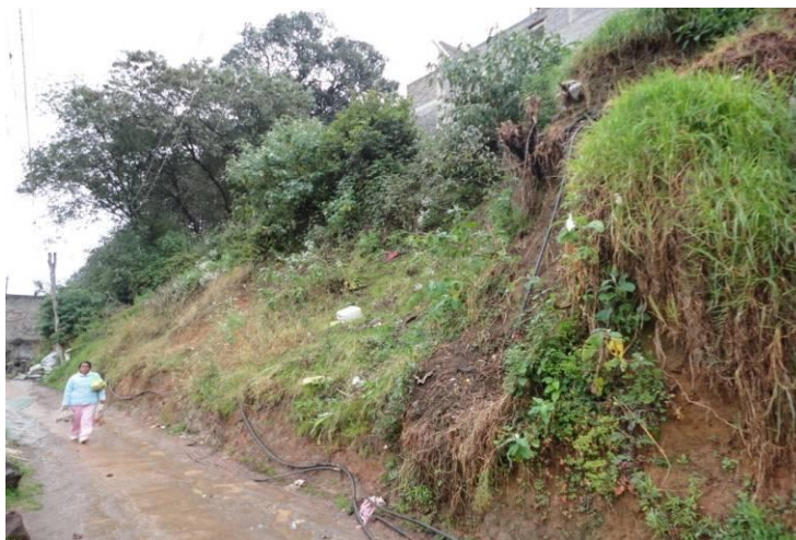
Evidencia de un deslizamiento, con señales de revegetación.
