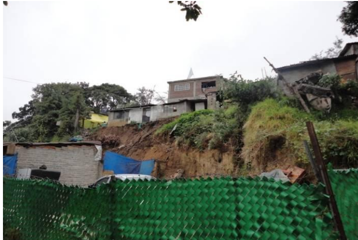
Cortes artificiales del terrero debido a que los vecinos del lugar continúan ampliando sus viviendas.
