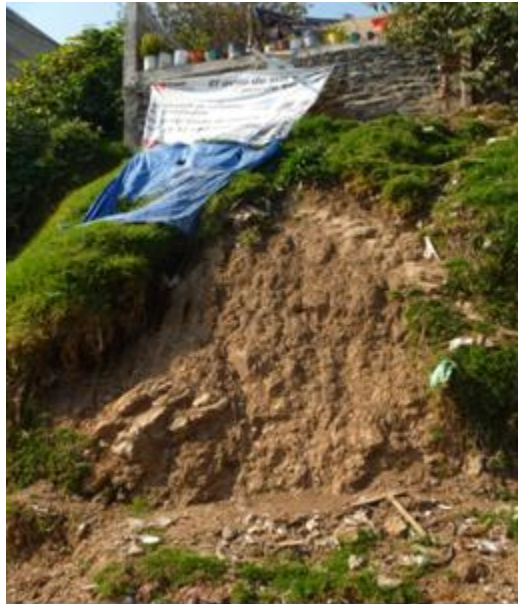
Deslizamiento ocurrido en un lahar sobre el cual caían descargas domiciliarias.
