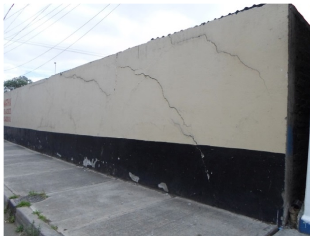
Figura 6. Fotografía de una vivienda que ha sufrido afectaciones asociadas al fenómeno de hundimiento, manifestándose por fracturas en el muro perimetral (sección media), que siguen una misma orientación; también se muestra asentamiento del elemento estructural (sección distal), que ha deformado la junta constructiva en la parte superior (19.3687° N; 99.0119° W. Calle: Carmino Arriaga).
