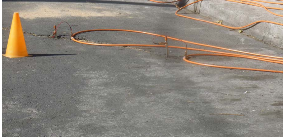
Figura 16. Fotografía donde se observan electrodos colocados a diferente profundidad, ello depende del grosor de la capa asfáltica (19.0021° N; 99.0143° W. Calle: Emilio Madero).
