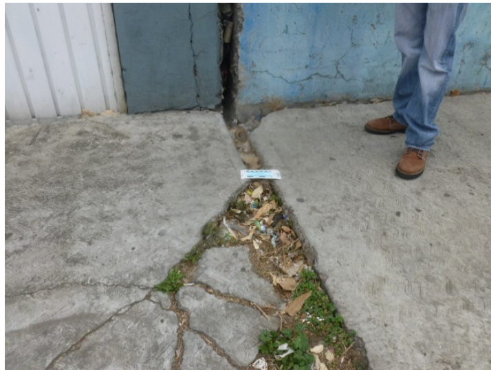
Figura 8. Fotografía que muestra una fractura asociada al desplazamiento vertical entre dos viviendas, que ha separado la unión de los bloques del pavimento que componen la acera, el bloque de la izquierda presenta ramificaciones en su parte proximal (19.3684° N; 99.014° W. Calle: Claudio Alcocer).
