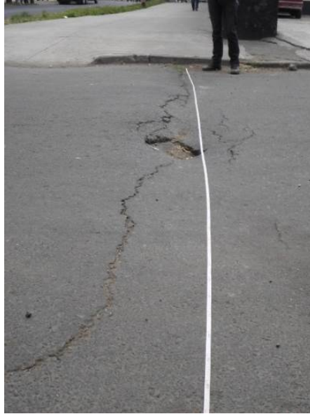
Figura 7. Fotografía que muestra una fractura en la carpeta asfáltica. Por las características elásticas que posee este material, las afectaciones se pueden manifestar en diferente grado, que van desde la pérdida de continuidad del material (extremos de la fractura), hasta un hundimiento de varios centímetros, asociado al esfuerzo vertical (hacia el terreno, zona media) producido por el hundimiento presente en la zona (19.3690° N; 99.0118° W. Calle: Carmino Arriaga).
