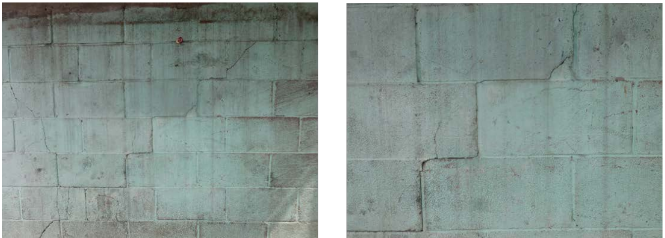
Figura 10. Fotografías que muestran una vivienda con una fractura en forma diagonal escalonada en su muro exterior, las juntas entre los block son zonas de debilidad que se separan al ceder ante el esfuerzo vertical ejercido por el hundimiento (19.3668° N; 99.0140° W. Calle: Cayetano Andrade).
