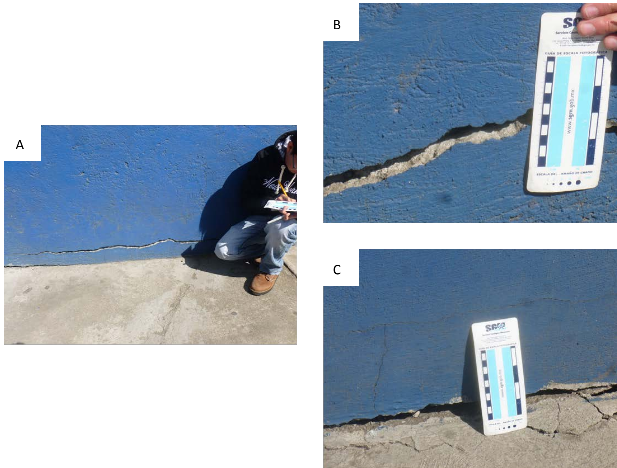
Figura 9. En la imagen A se muestra una vivienda afectada por una fractura horizontal. La fotografía B muestra la separación de la fractura en el mismo muro, y la imagen C se observa la separación entre la acera y el muro (19.3675° N; 99.0160° W. Calle: Cayetano Andrade).
