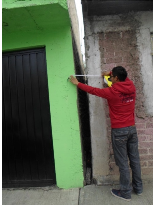
Figura 5. Fotografía que muestra dos viviendas. El inmueble de la izquierda presenta un asentamiento por lo cual la junta constructiva que comparten ambas viviendas se ha separado (19.3684° N; 99.0120°W. Calle: Carmino Arriaga).
