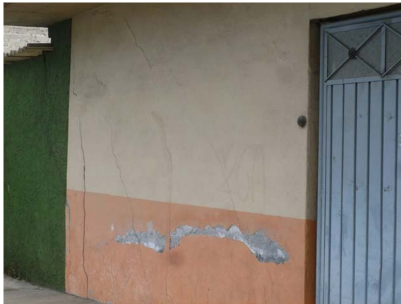
Figura 12. Fotografías que muestran una vivienda con fracturas verticales y diagonales que afectan el muro, además de degradación en la parte inferior del mismo (19.3684° N; 99.01417° W. Calle: Claudio Alcocer).
