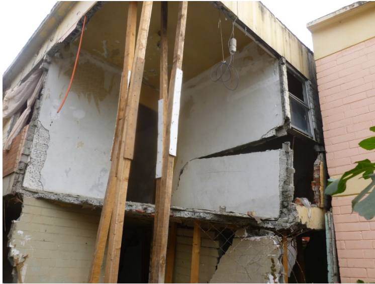
Figura 6. Fotografía de vivienda con fracturas diversas y colapsos parciales (19.3716° N, 99.0329° W. Calle: Retorno 1 Legión del Norte).
