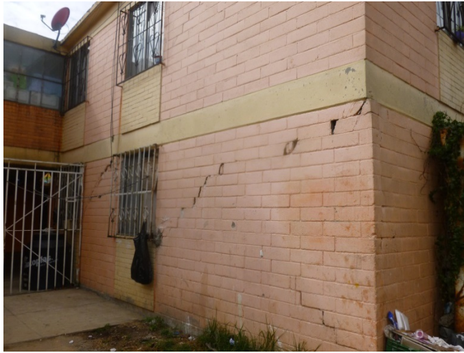
Figura 8. Fotografía que muestran viviendas con diversas fracturas en muros exteriores y el hundimiento en la carpeta asfáltica (19.3716° N, 99.0329° W. Calle: Retorno 1 Legión del Norte).
