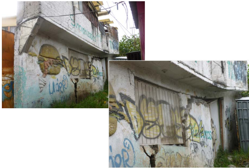
Figura 7. Fotografías que muestra una vivienda con múltiples fracturas en muros exteriores y deflexión de la losa (19.3716° N, 99.0329° W. Calle: Retorno 1 Legión del Norte).
