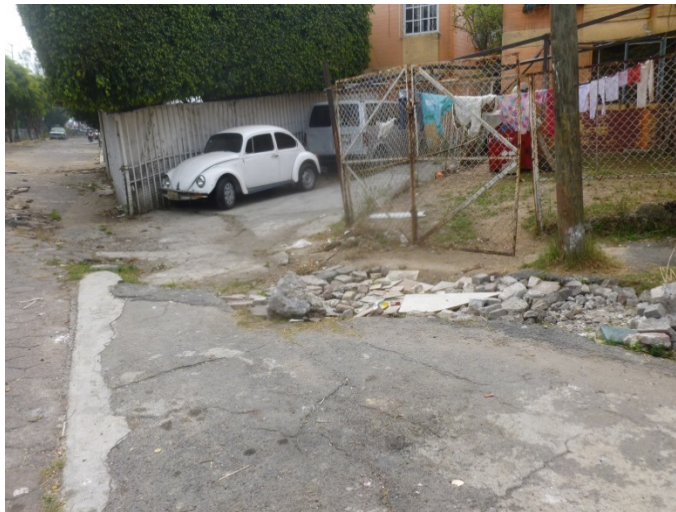
Figura 9. Fotografía que muestran la estructura del hundimiento, que afecta tanto el recubrimiento asfáltico como al adoquín (19.3717° N, 99.0329° W. Calle: Retorno 1 Legión del Norte).
