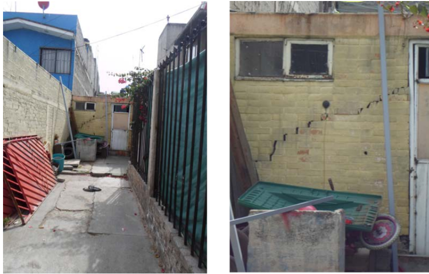
Figura 12. Fotografías que muestran una vivienda con varias fracturas en el muro exterior en forma diagonal escalonada (19.3681° N; 99.0310° W. Calle: Rafael Saldaña).
