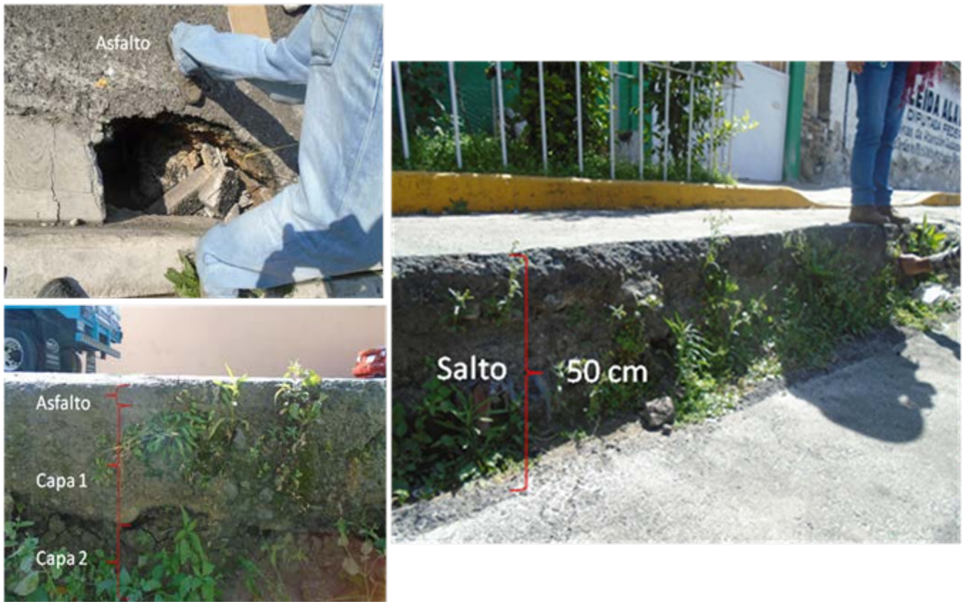
Figura 30. Estas imágenes ejemplifican el fenómeno donde el agua que satura los materiales de la Capa 2 se filtra desde la superficie por medio de huecos (fotografía superior izquierda), fracturas, hundimientos (fotografías inferior izquierda y derecha) o fuga de los drenajes (Las fotografías no pertenecen a la zona).
