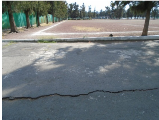
Figura 5. Fractura al interior del deportivo Santa Cruz Meyehualco, la cual se extiende por el pasillo central y continúa hacia la colonia Jacarandas al poniente (19.3486° Lat. N; 99.0484° Long. O. Calle: Calle 71).
