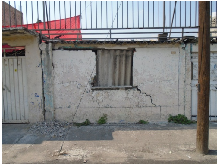
Figura 9. Vivienda afectada por la zona de hundimiento que se prolonga sobre el terreno, la casa carece de confinamiento en la ventana (con castillos y cadenas), lo que impide compatibilizar las deformaciones en los muros producto de los asentamientos (19.3452° N; 99.0417° W. Calle: Calle 43).
