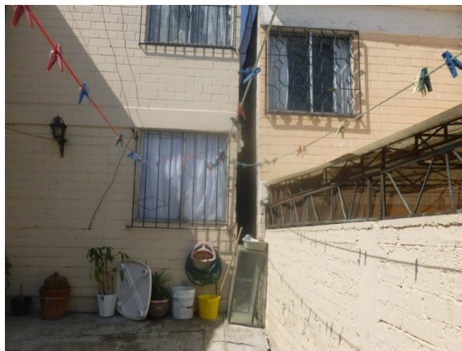
Figura 6. Fotografía que muestra dos edificaciones. La de la derecha sufre un hundimiento con respecto a la otra que se puede apreciar en la altura de las ventanas y que además provocó que la junta constructiva sufriera una separación de aproximadamente 10 cm ( 19.3625^\circ N, 98.9980^\circ W. Calles: José Pagola y Niño Artillero).
