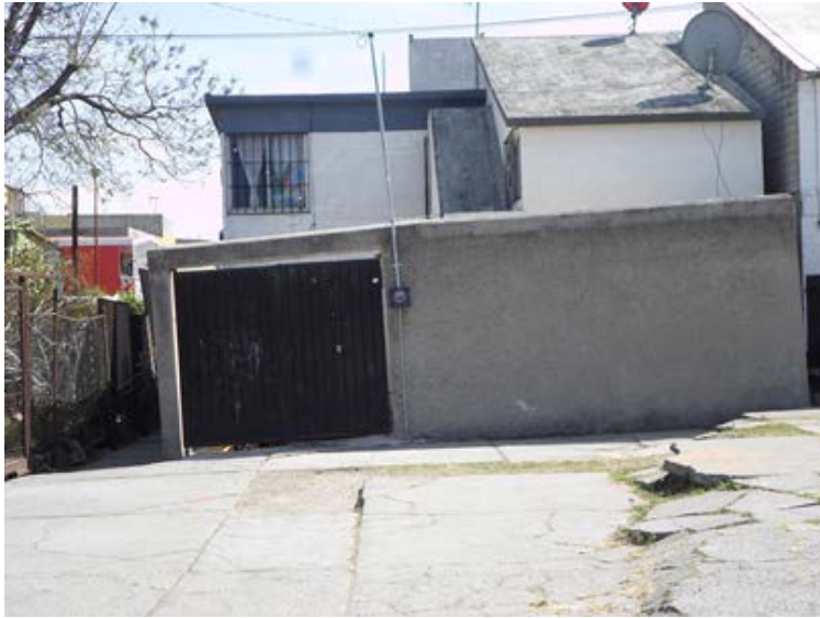
Figura 7. Fotografía que muestra la estructura de hundimiento en la calle que provoca que la vivienda tenga un hundimiento hacia su lado izquierdo, esto da lugar a que la junta constructiva tenga una longitud mayor en la parte superior (19.3627° N, 98.9985° W. Calles: Retorno de Niño Artillero y Padre Carbajal).
