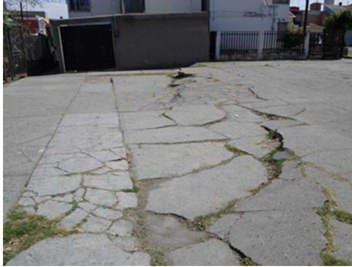
Figura 5. Fotografía que muestra una zona afectada por el hundimiento local, que ocasionó múltiples fracturas y un desplazamiento vertical en el pavimento afectando también las viviendas ( 19.3627^\circ N, 98.9985^\circ W. Calles: Retorno de Niño Artillero y Padre Carbajal).
