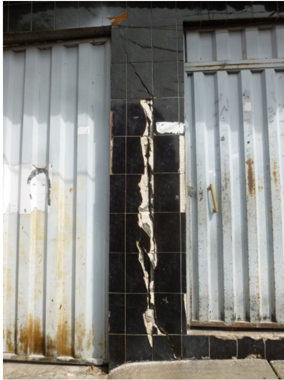
Figura 9. Fotografía que muestra las afectaciones en la fachada de la vivienda, al parecer, continúa hacia el interior de la misma (19.2949° N, 99.0670° W. Calle: Alcanfores).
