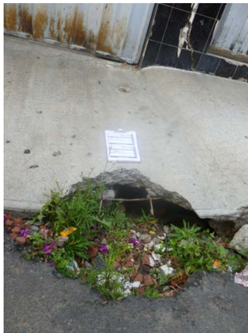
Figura 8. Fotografía que muestra una oquedad que afecta la acera. Se observa que continúa debajo de la acera de concreto reforzado y que ha sido rellenada con desechos (19.2949° N, 99.0670° W. Calle: Alcanfores).
