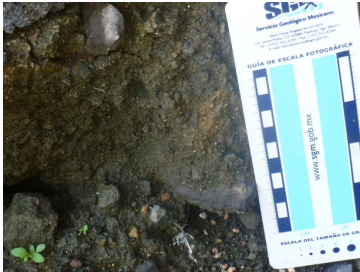
Figura 7. Fotografía que ilustra los materiales observados en el interior del hueco compuesto por materiales finos, intercalados con material grueso y restos del recubrimiento asfáltico (19.2949° N, 99.0670° W. Calle: Alcanfores).
