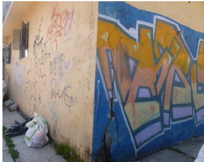
Figura 6. Fotografía que ilustra una vivienda con fractura vertical en el muro, también se puede observar caída del recubrimiento (19.2967° N, 99.0672° W. Calle: Encino).
