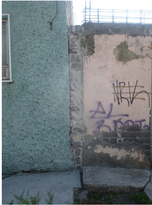
Figura 5. Fotografía que muestra una vivienda que presenta un asentamiento debido a hundimiento local. La junta constructiva se ha deformado por dicho fenómeno, como puede observarse en la parte superior de la misma (19.2971° N, 99.0675° W. Calle: Ciprés).
