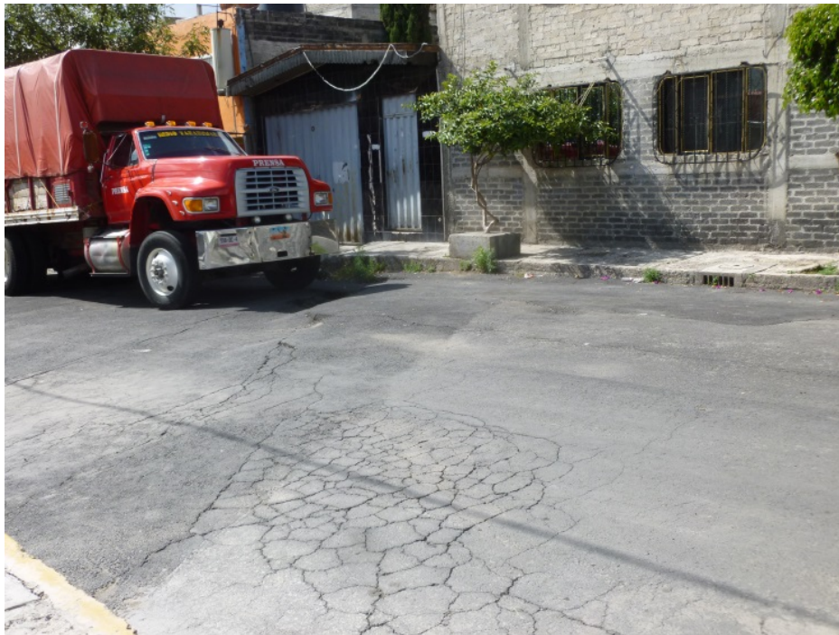
Figura 10. Fotografía que muestra la zona de hundimiento con una longitud de 13.40 m y un ancho que varía de 2.10 a 3.70 m (19.2949° N, 99.0670° W. Calle: Alcanfores).
