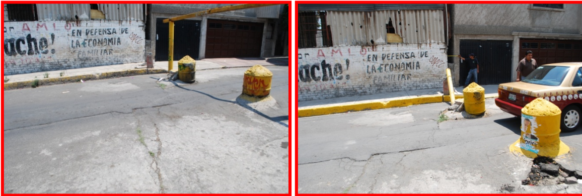
Figura 7. Fracturamiento del subsuelo en la Calle de Insurgentes esquina Encino.
