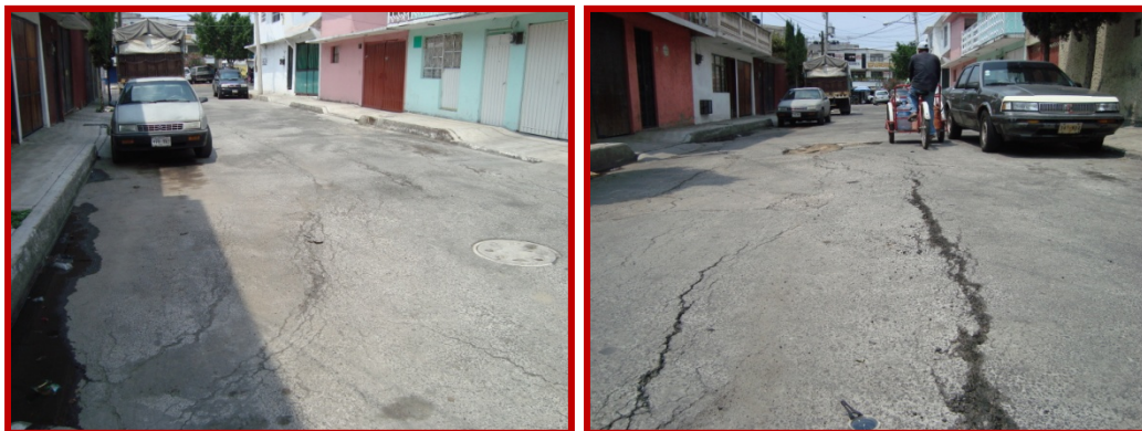
Figura 8. Fracturamiento del Subsuelo en la Cerrada de Jesús Araujo, la cual es paralela a lo largo de toda la calle
