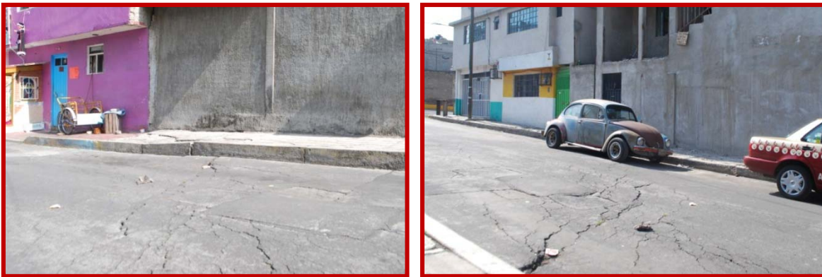
Figura 9. Fracturamiento del subsuelo y sus efectos sobre la infraestructura y equipamiento urbano.
