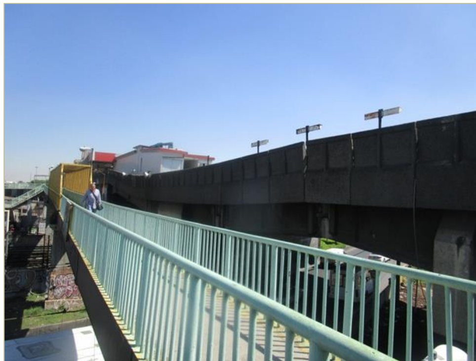
Figura 5.1.7.3 Flexión del cajón del Metro línea nueve debido a un hundimiento diferencial, sobre Avenida Pantitlán y Canal Churubusco
