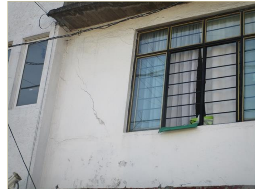
Figura 5.1.7.4 Fisuramiento diagonal en muro semiconsolidado de casa habitación originado por el hundimiento en edificio en la calle Cerrada 1 Río Churubusco y Río Churubusco.
