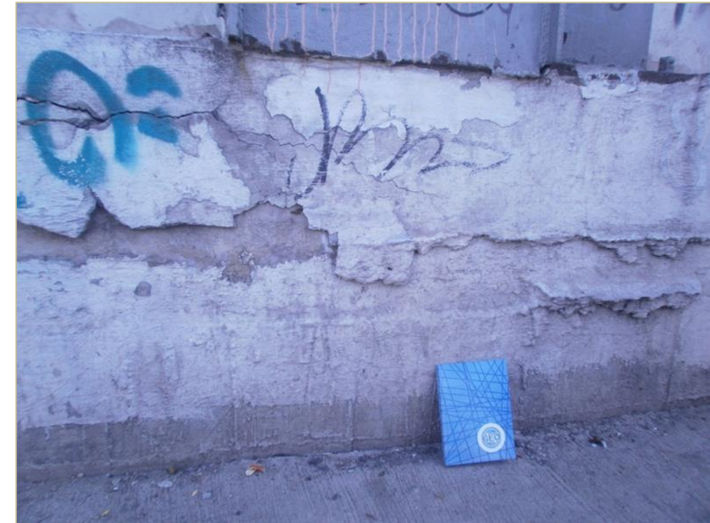
Figura 5.8.1.6. Se observa tres niveles de subsidencia al que se ha sometido el inmueble, el primero de 34 cm, el segundo de 12 cm y el tercero de 24 cm.
