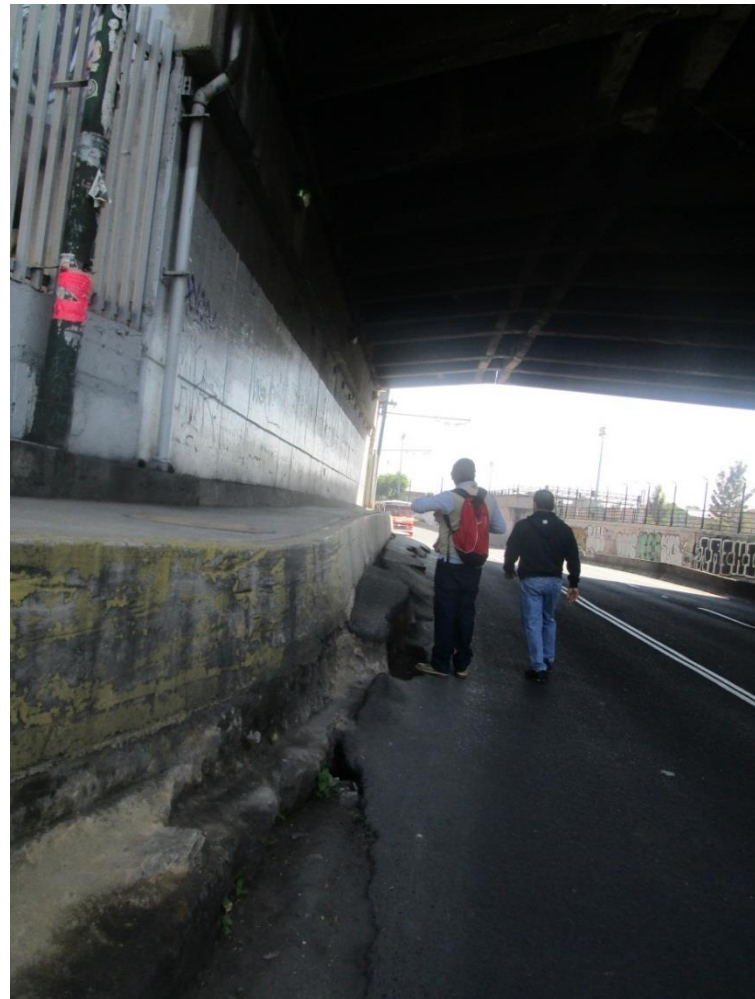
Figura 5.1.9.6. Agrietamiento NW-SE con un salto de 40 centímetros, afectando a la vialidad de Avenida Pantitlán.
