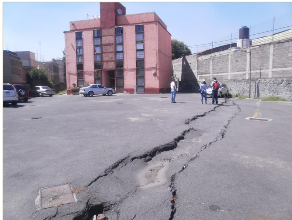
Figura 5.1.9.1. Agrietamiento en la Delegación Iztacalco.
