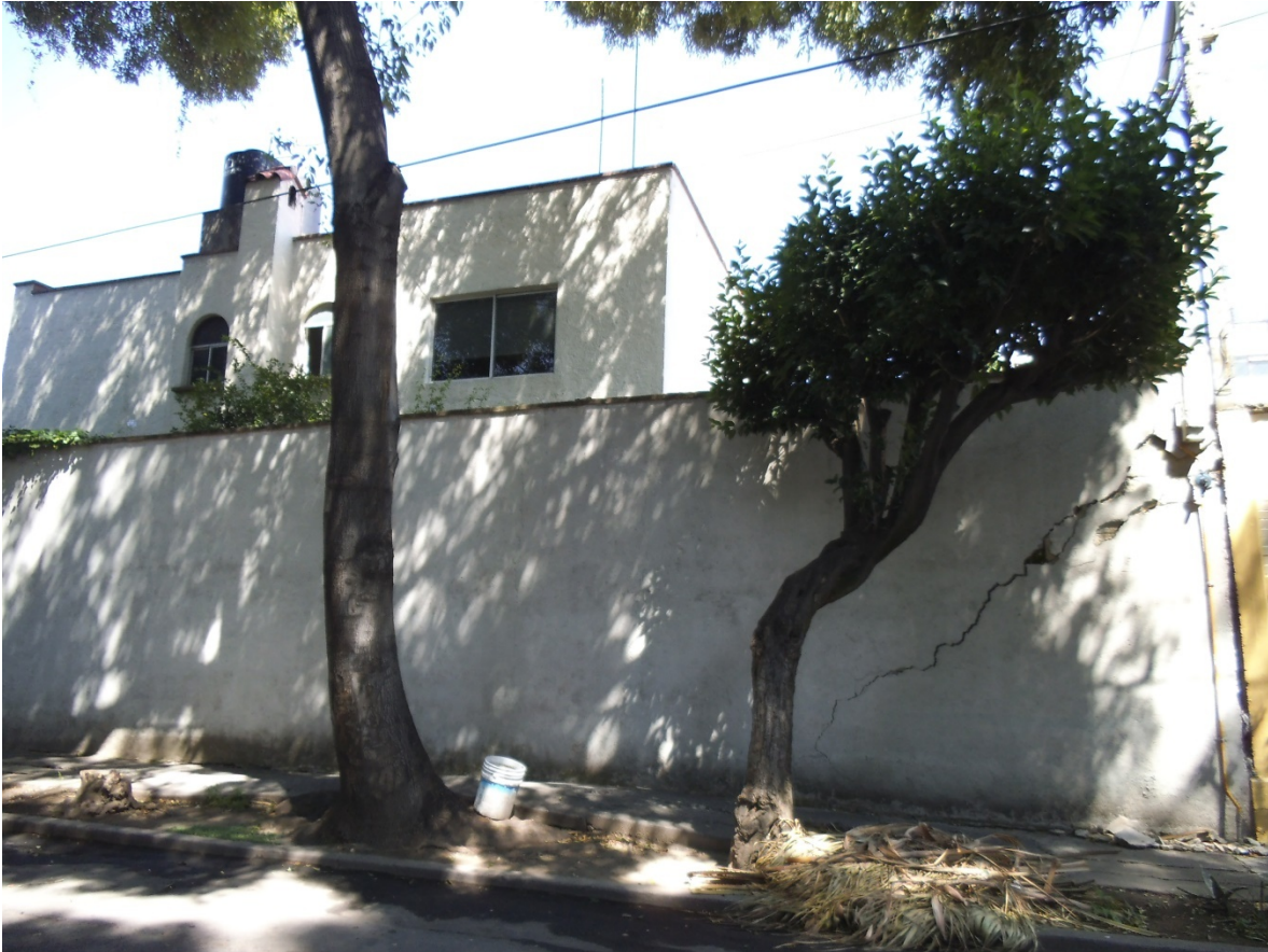
Figura 5. fracturamiento en muro perimetral de una vivienda, la fractura parte de la zona superior del muro en la colindancia en dirección diagonal hacia la zona de piso terminado; se observa que la raíz del árbol ha dañado la banquetta, por lo que se infiere el comportamiento del muro (19.3948° N, 99.1130° W. Calle: Chinampas).).
