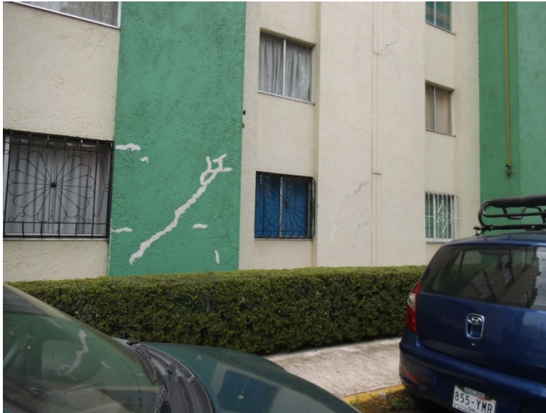
Figura 7. Se observan las afectaciones en los edificios, las cuales se encuentran principalmente en la planta baja de éstos donde se producen fracturas diagonales por el hundimiento (19.5078° N, 99.1559° W. Calle: S.C.T.).
