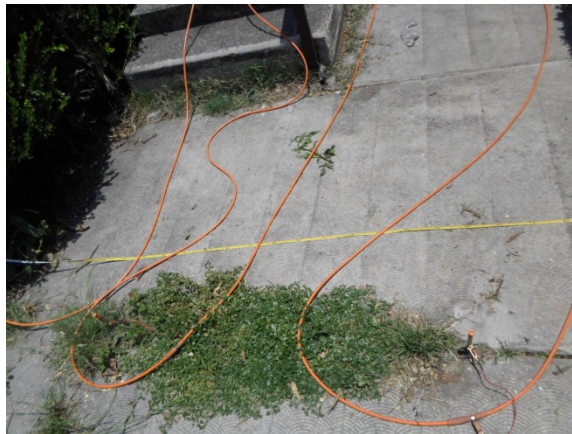
Figura 13. Fotografía donde se observan electrodos colocados en contacto con el terreno (19.5084° N, 99.1564° W. Calle: Telecomunicaciones).
