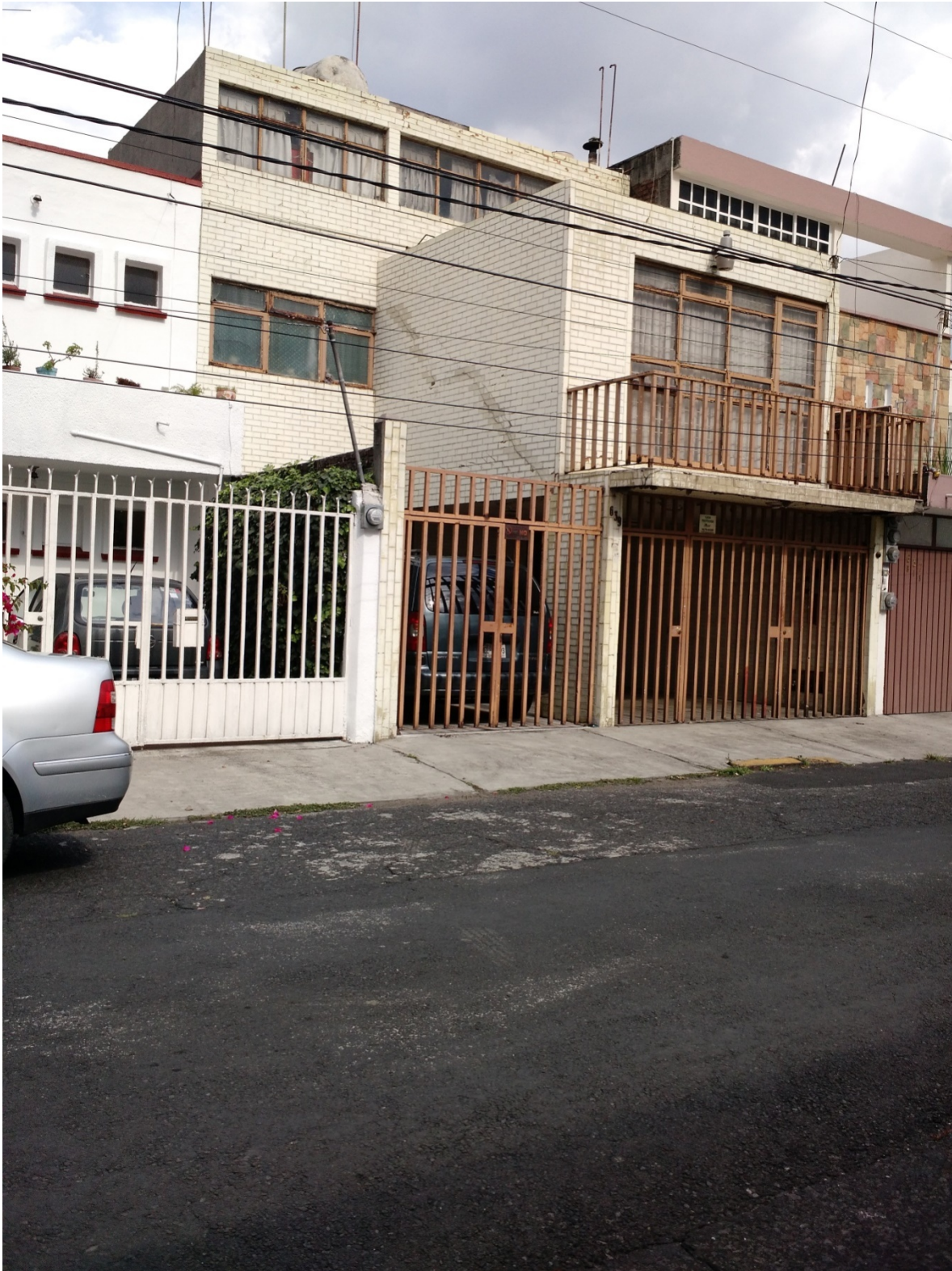
Figura 6 Fotografía C (Imagen 48), fracturamiento en la fachada lateral de una vivienda; la fractura atraviesa todo el muro desde la esquina superior izquierda hasta la esquina inferior derecha (19.4901° N, 99.1380° W. Calle: Recife)
