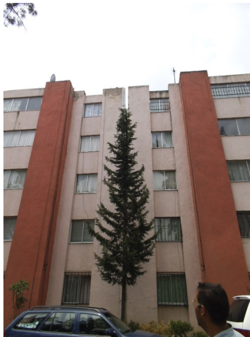
Figura 6. Incremento en la separación de la parte superior de las juntas constructivas, presencia de humedad en el pretil y daño en acabados (19.5084° N, 99.1558° W. Calle: S.C.T.)
