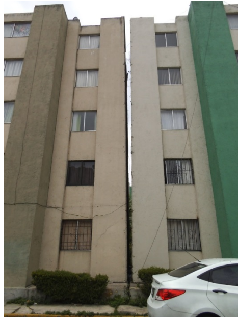
Figura 5. Junta constructiva con separación mayor a lo establecido en la norma de construcción. La separación es mayor en la parte superior de los edificios (19.5079° N, 99.1566° W. Calle: Caminos).
