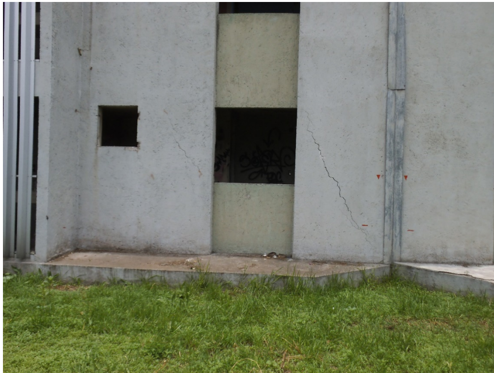
Figura 9 Inmueble desalojado con fracturas diagonales a lo largo de los muros de carga que presentan apertura, al costado de la ventana, y cargas no distribuidas concentradas en la base del edificio (19.5084° N, 99.1564° W. Calle: Telecomunicaciones).
