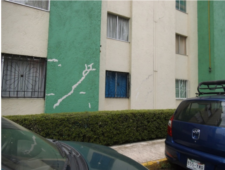
Figura 7. Se observan las afectaciones en los edificios, las cuales se encuentran principalmente en la planta baja de éstos donde se producen fracturas diagonales por el hundimiento (19.5078° N, 99.1559° W. Calle: S.C.T.).
