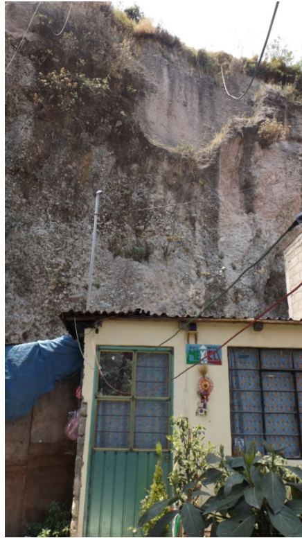
Figura 4. Se muestra una vivienda desplantada al pie de un talud de aproximadamente 20 m compuesto de depósitos de flujos piroclásticos, el cual no presenta algún tipo de protección o recubrimiento; en la parte superior se distingue una cicatriz de derrumbe (19.3682° N, 99.2769° W. Calle: sin nombre oficial).
