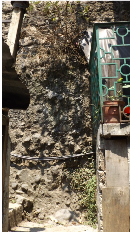
Figura 5. Viviendas aledañas a un talud compuesto de bloques con matriz de cenizas intemperizadas; no presenta algún tipo de protección o recubrimiento, dejando expuesto el material litológico a la erosión (19.3678° N, 99.2771° W. Calle: sin nombre oficial).
