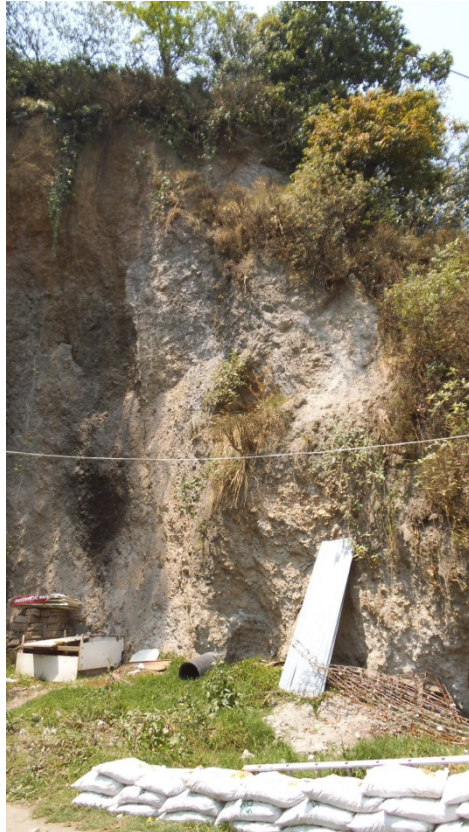
Figura 3. Talud de aproximadamente 20 m de altura, compuesto de bloques y cenizas, el cual se encuentra expuesto a la erosión. Al pie del mismo se distinguen algunos costales rellenos, apilados para la construcción de un muro de contención (19.3694° N, 99.2771° W. Calle: sin nombre oficial).
