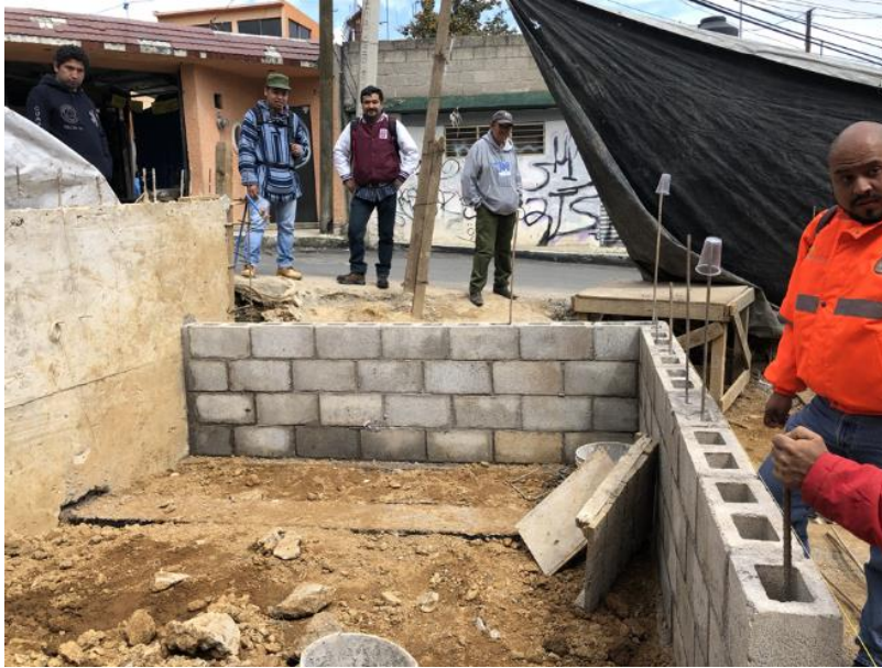
Imagen 30 Daños que afectaron a viviendas en San Pablo Chimalpa.
