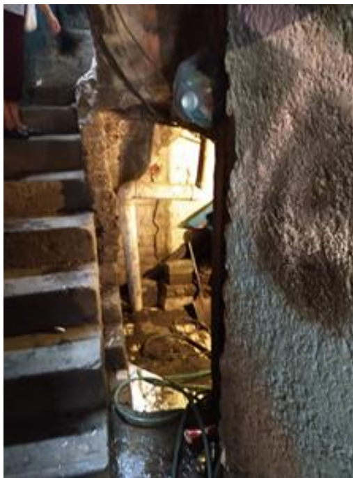
Imagen 16 Vista interior de una vivienda ubicada en Calle Porfirio Díaz No. 9 con deficiencias en su sistema de drenaje
