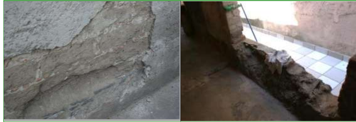
Ilustración 105. Problemas estructurales en viviendas de roca-adobe en el centro de Coyoacán.
