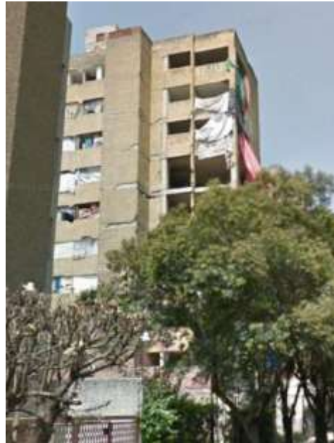
Ilustración 1. Inmueble dañado por sismos de 1985 (Colonia Paseos de Taxqueña)
