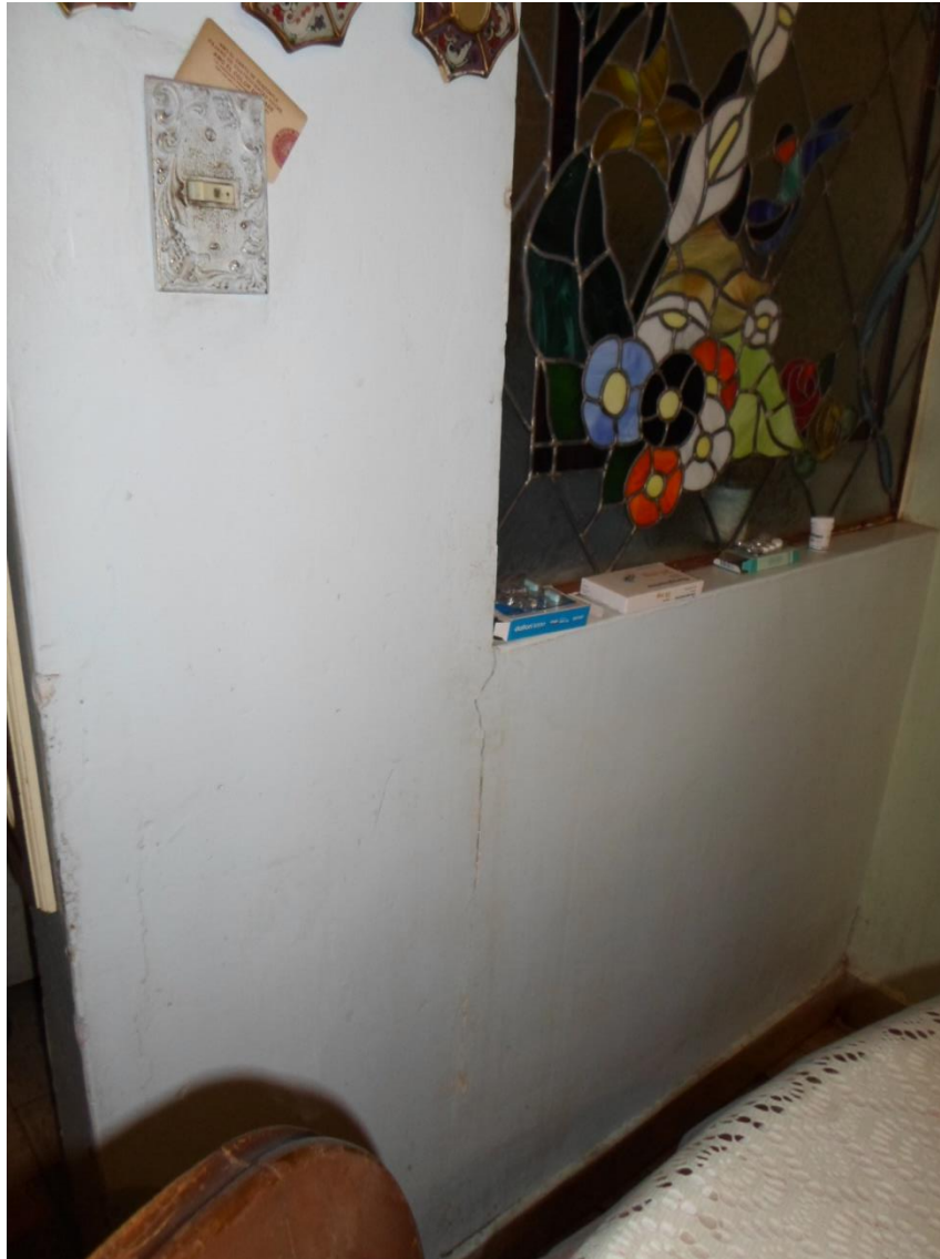
Figura 7. Se observa una grieta en muro interior de vivienda la cual parte de la zona inferior derecha del marco de la ventana por posible falta de confinamiento (19.4849º N; 99.1733º W. Calle: Soledad).
