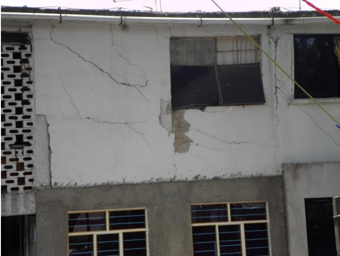
Figura 8. Consolidación diferencial la cual causó el agrietamiento de muro, el descuadre de ventanas y la separación y quiebre de ladrillos no portantes los cuales denotan una separación mayor conforme se observa la zona superior de estos (19.4847° N; 99.1723° W. Calle Soledad).
