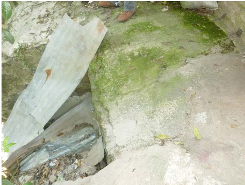
Figura 4. Fotografía que muestra acceso bloqueado con madera y láminas metálicas (19.3136° N; 99.2688° W. Calle: 10 de mayo).
