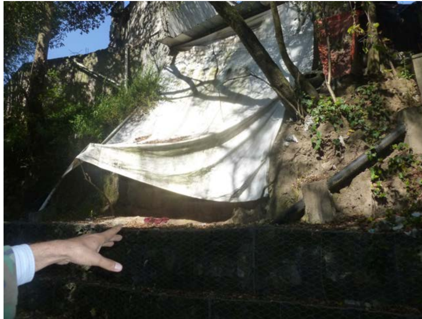
Figura 9. Pared de la barranca donde se ha implementado el uso de lonas plásticas para evitar que la lluvia sature los materiales que constituyen las paredes y socaven la zona donde se desplanta la vivienda (19.3205° N, 99.2643° W. Calle: Emiliano Zapata).
