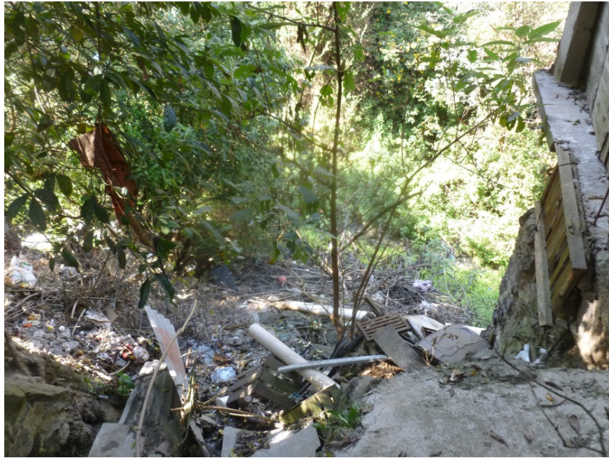
Figura 7. Muro colocado en un acceso a la barranca hecho con madera y lámina, en la ladera sobre la que se encuentra se observan materiales que anteriormente constituían esta barda (19.3136° N, 99.2688° W. Calle: 10 de mayo).
