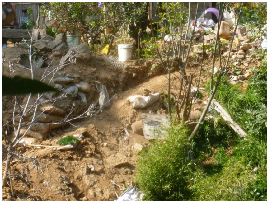
Figura 8. Se muestra un muro hecho a base de costales rellenos de materiales finos los cuales presentan deterioro del saco contenedor permitiendo que dicho material sea llevado por procesos gravitacionales ladera abajo (19.3117° N, 99.2706° W. Calle: 29 de octubre).
