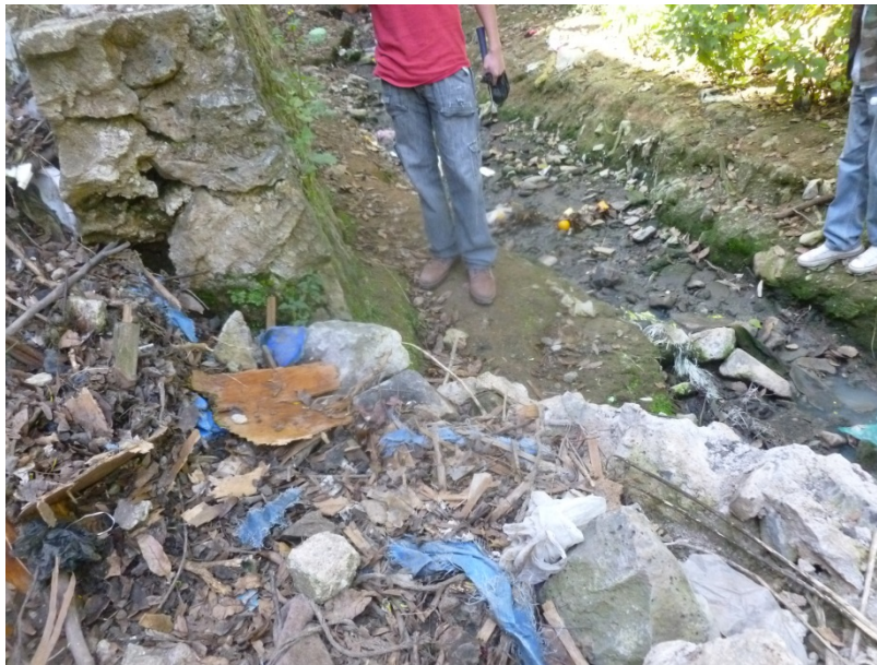
Figura 6. Muro de mampostería y mortero que presenta fracturas y colapso en la parte del cauce de la barranca; el peso de los materiales sólidos se incrementan con el agua proveniente de la parte superior (19.3205° N, 99.2643° W. Calle: Emiliano Zapata).
