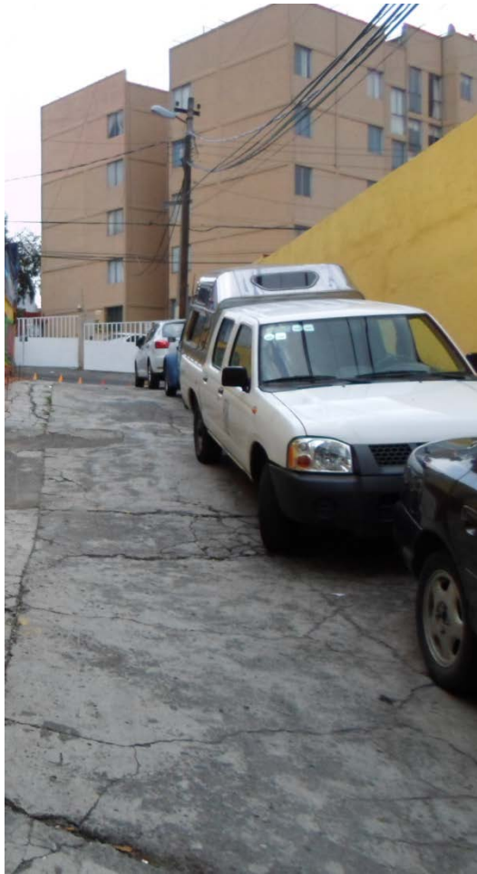
Figura 4. Se muestra el fracturamiento en el concreto de la calle (19.3481° N; 99.2285° W. Calle: Asperillas).
