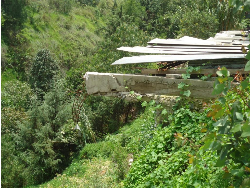
Figura 22. Pared de barranca donde se observa el desprendimiento de un elemento de una construcción, asociado a la pérdida de materiales en donde se encontraba desplantada la vivienda (19.3569° N, 99.2164° W. Calle: Tarango).
