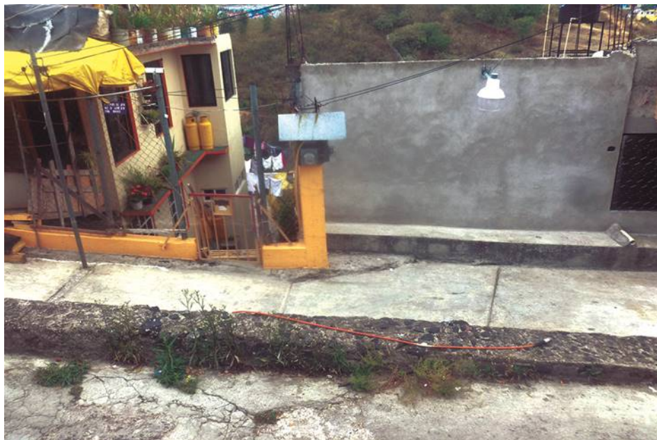
Figura 18. Se observa el fracturamiento en lanzado de concreto, el cual junto con el muro de retención de mampostería mitigan el deslizamiento del talud (19.3783° N; 99.2337° W. Calle: Paseo Lomas de Jalapa).
