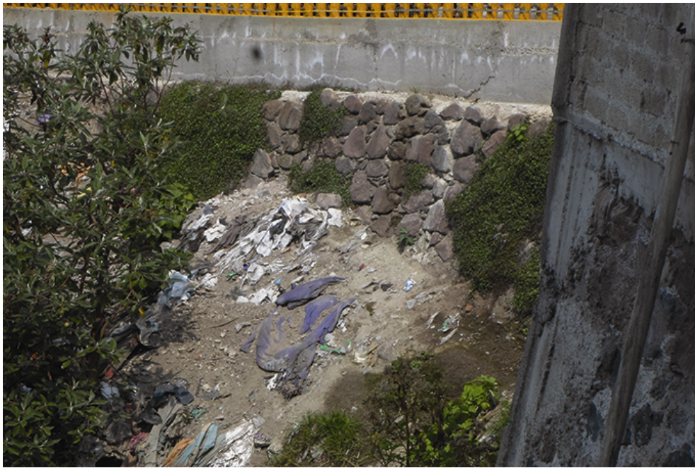
Figura 4. Imagen donde se observa un muro de mampostería cuya base tiene presencia de residuos sólidos urbanos (19.3815° N, 99.2462° W. Calle: Barranca La Morena).
