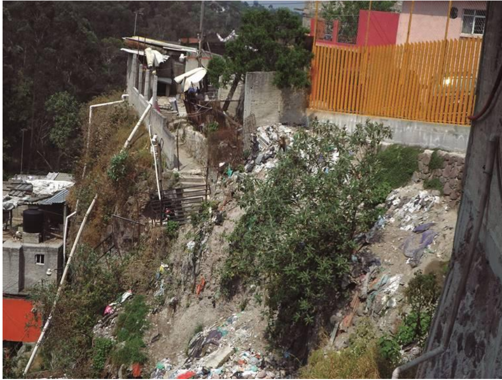
Figura 19. Pared de barranca con pendiente fuerte la cual presenta materiales poco compactos cubiertos por cascajo y basura (19.3783° N, 99.2337° W. Calle: Barranca La Morena).
