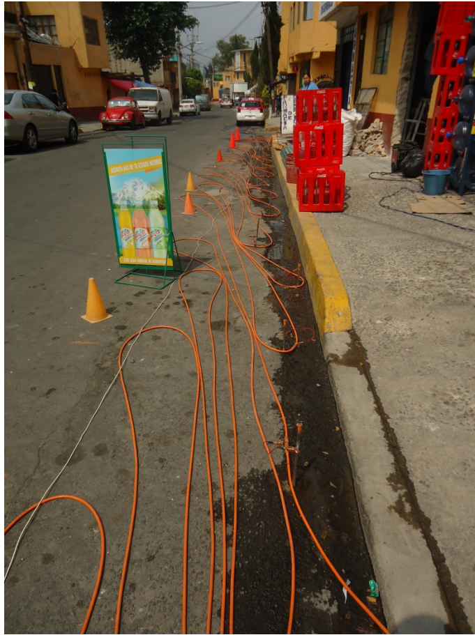
Figura 7. Se muestra el tendido del cable sobre la cual se realizó el estudio (19.3796° N, 99.2063° W. Calle: Benito Juárez).
