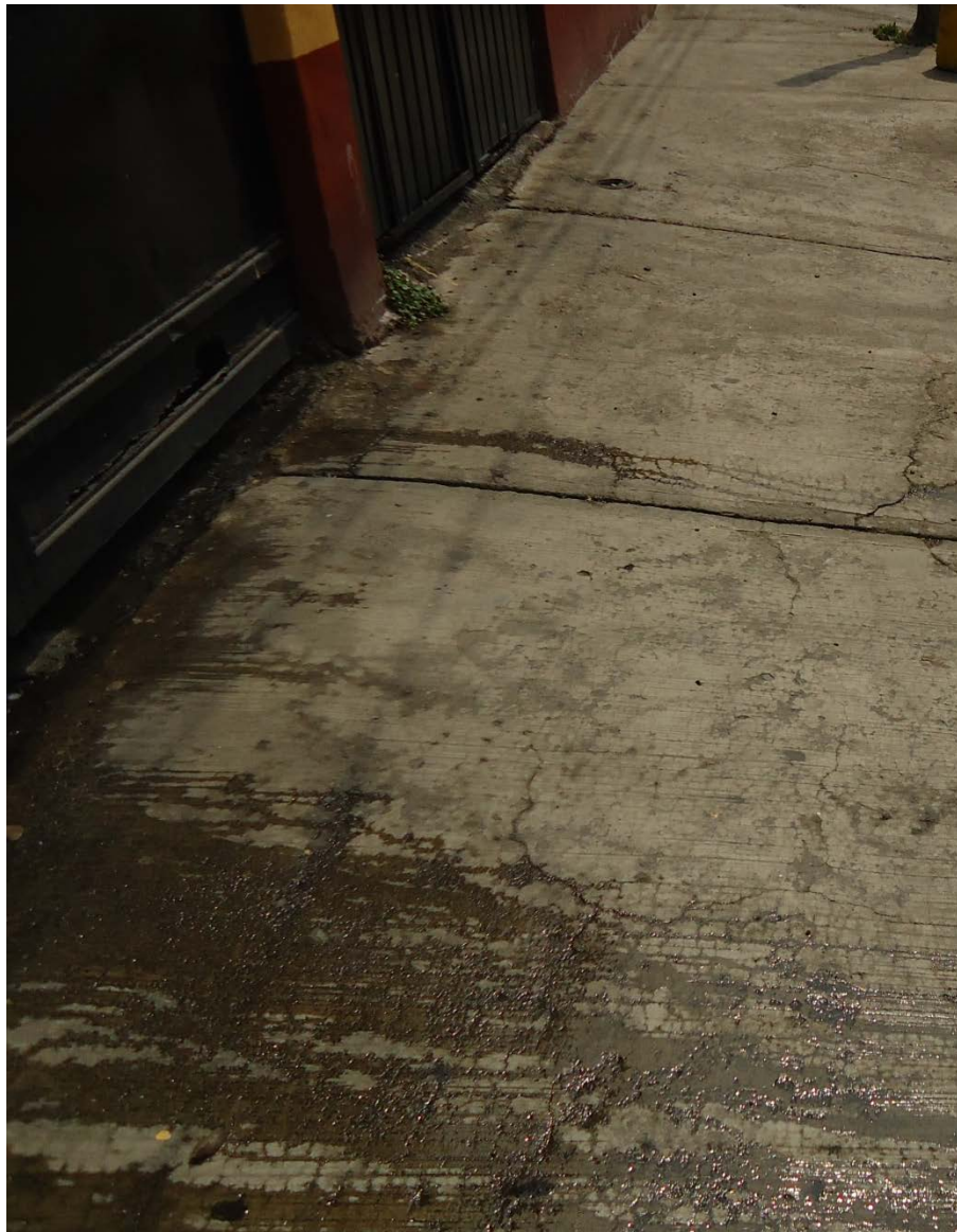
Figura 3. Se observa el fracturamiento en el concreto de la calle (19.3795º N, 99.2064º W. Calle: Benito Juárez).
