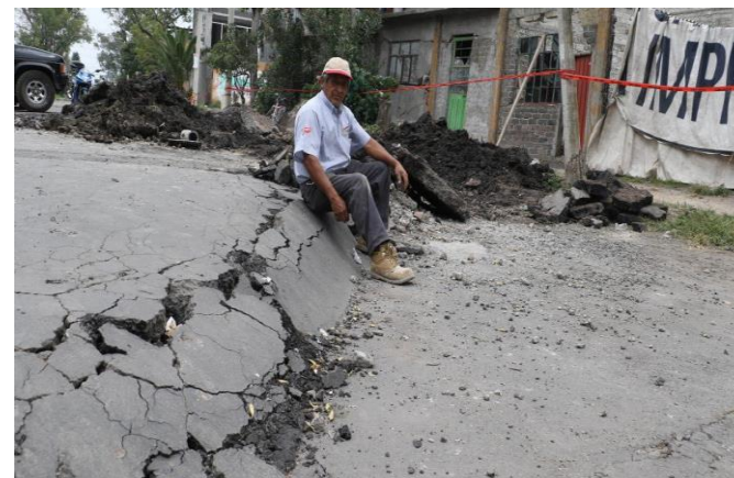
Figura 36. Grieta en la delegación Tláhuac.
