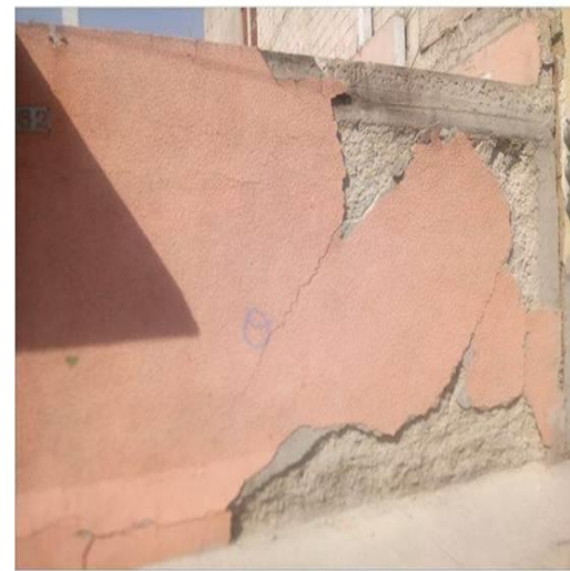
DAÑOS ESTRUCTURALES POR GRIETA GEOLÓGICA
