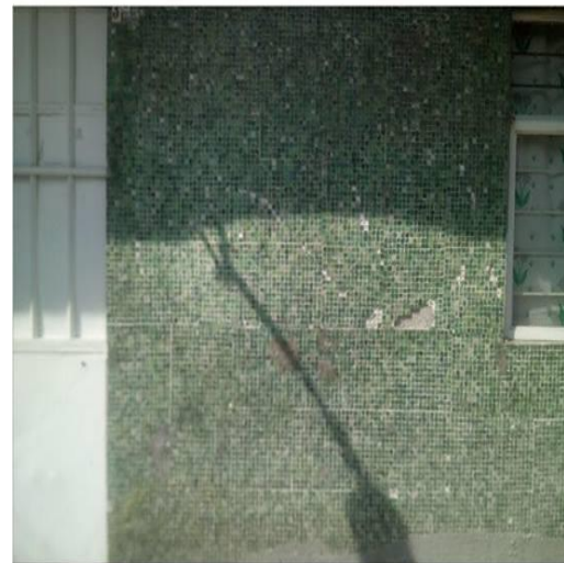
DAÑO ESTRUCTURAL POR GRIETA GEOLÓGICA
