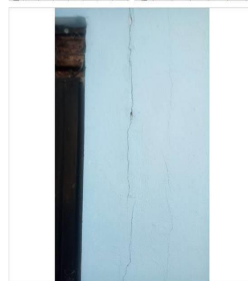
DAÑOS ESTRUCTURALES POR GRIETA GEOLÓGICA
