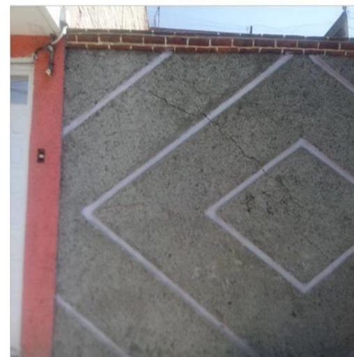
DAÑO ESTRUCTURAL POR GRIETA GEOLÓGICA
