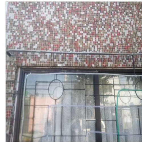
DAÑOS ESTRUCTURALES POR GRIETA GEOLÓGICA
