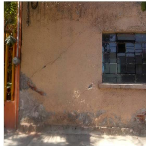
DAÑO ESTRUCTURAL POR GRIETA GEOLÓGICA
