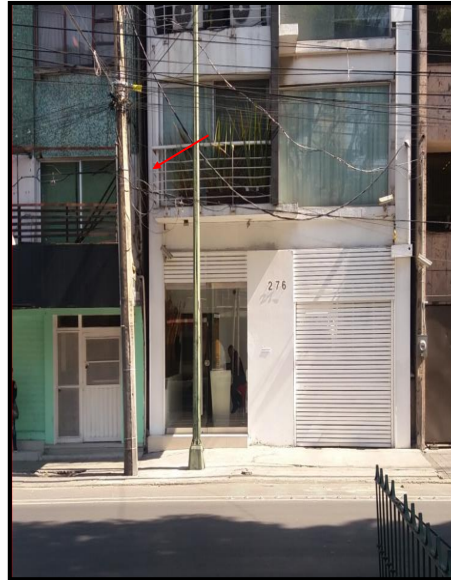
Coordenada UTM Geográfica 2148513.905 484958.9128 19°25'50.40"N 99°08'35.79"O Ubicación Delegación Cuauhtémoc, colonia Centro, zona oriente. Observación Agrietamiento entre los límites de las construcciones.
