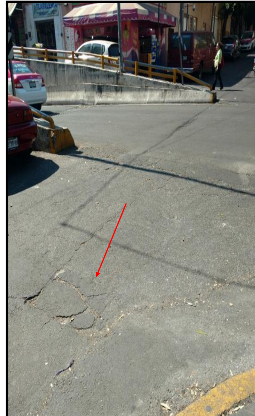
Coordenadas UTM 2145380.71 m N 478766.35 m E Geográficas N 19.402537° O 99.202236° Ubicación Av. Sur 128. Col. América Observación Agrietamiento
