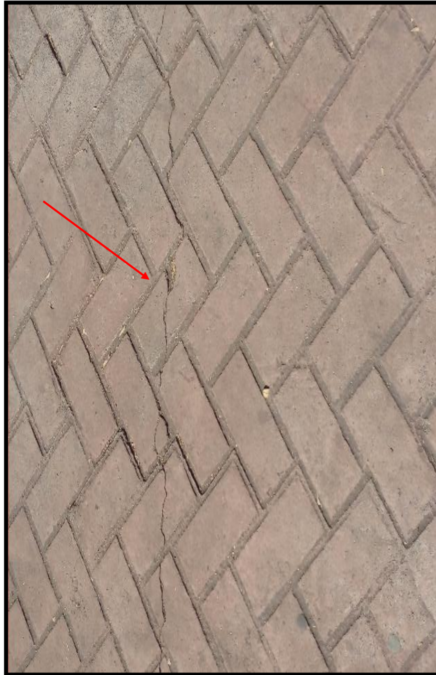
Coordenadas UTM 14Q 481788.2271 2150567.325 Geográficas 19 ° 26 ' 57.11 " -99 ° 10 ' 24.59 " Ubicación Calle Felipe Carrillo Puerto, Popotla Observaciones Fractura en la banqueta
