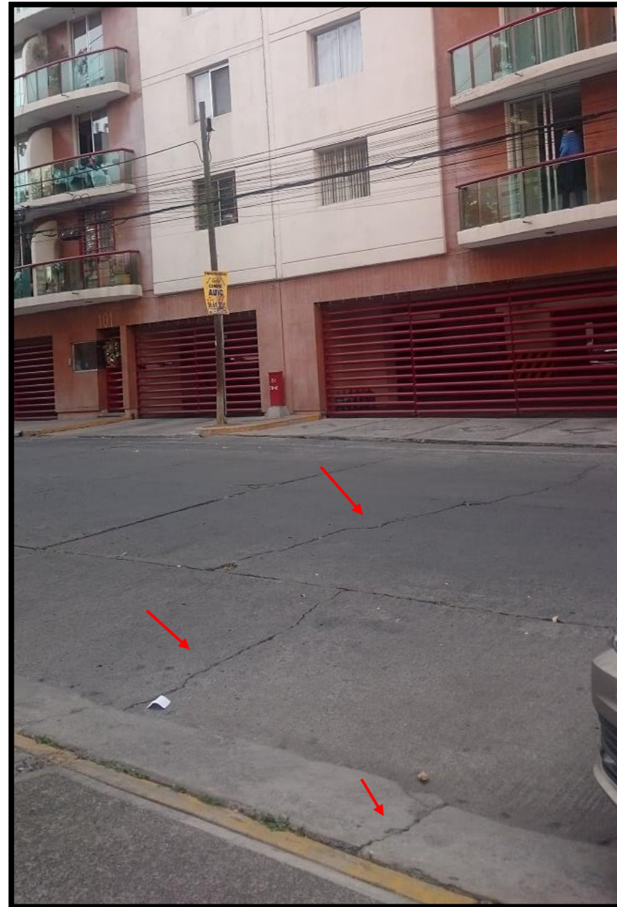
Coordenadas UTM Geográficas 2145112.66 m N N 19.400144° 481748.36 m E O 99.173832° Ubicación Calle. Sindicalismo. Col. Escandón Observación Agrietamiento
