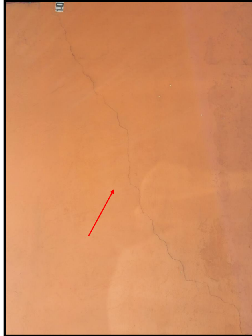
Coordenada UTM Geográfica 2151393.032 19°27'23.99"N 482312.1314 99°10'6.65"O Ubicación Delegación Nueva Santa María Calzada de los Gallos 63, Plutarco Elías Calles, 11 Observación Agrietamiento sobre una casa
