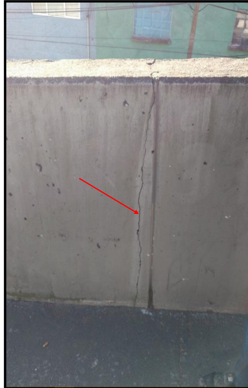
Coordenadas UTM 2144993.44 m N 479317.97 m E Geográficas N 19.399043° O 99.196978° Ubicación Calle. Minas de Arena. Col. José María Pino Suarez. Observación Agrietamiento
