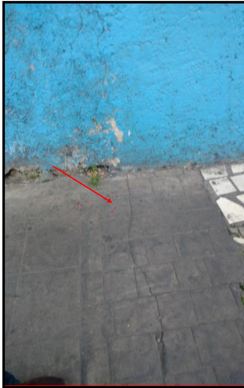
Coordenadas UTM Geográficas 2145083.83 m N N 19.399871° 480432.72 m E O 99.186362° Ubicación Calle. Transito Col. Tacubaya Observación Agrietamiento
