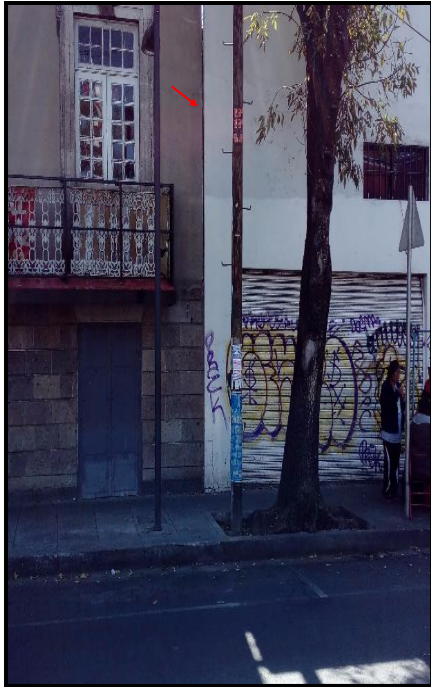
Coordenadas UTM Geográficas 14Q 481926.987 19 ° 26 ' 56.06 " 2150534.911 - 99 ° 10 ' 19.83 " Ubicación Calle Felipe Carrillo Puerto, Popotla Observaciones Separación de los edificios
