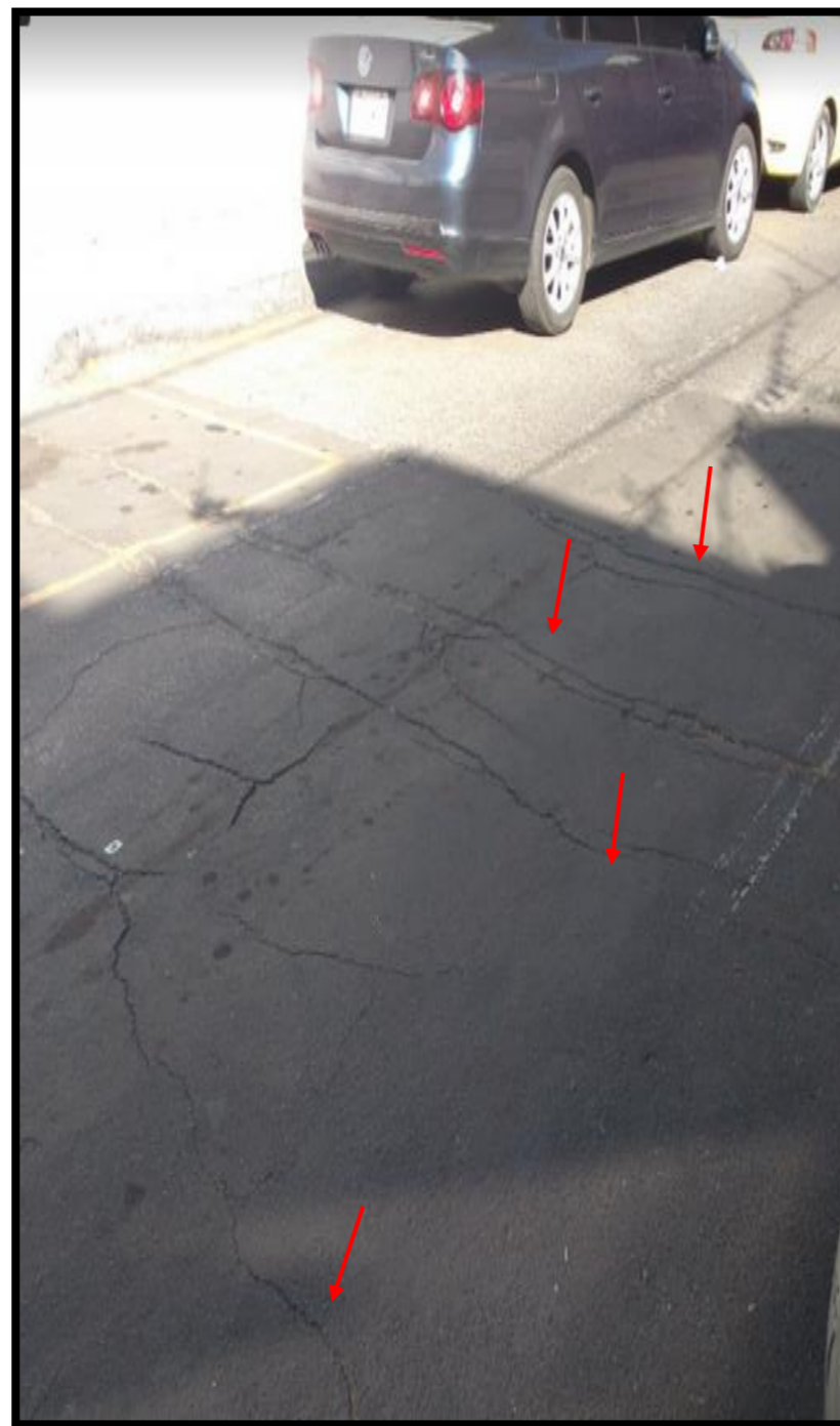
Coordenadas UTM 2145398.67 m N 480506.56 m E Geográficas N 19.402717° O 99.185662° Ubicación Calle. Joublanc. Col. Tacubaya Observación Agrietamiento
