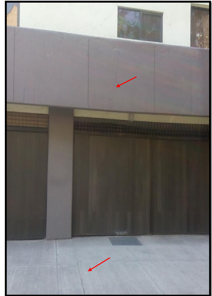
UTM Geográficas Coordenadas 14Q 482126.2458 2146515.163 19 ° 24 ' 45.29 " -99 ° 10 ' 12.86 " Ubicación Calle Laredo, Hipódromo Observaciones Fractura desde la banqueta hasta la parte superior de la construcción
