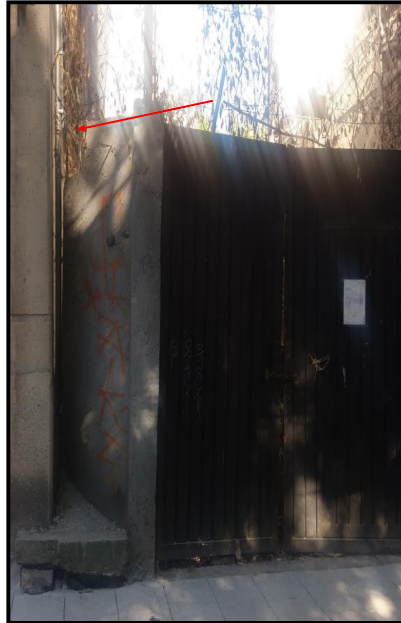
UTM Geográficas Coordenadas 14Q 482229.3745 2146696.105 19 ° 24 ' 51.18 " -99 ° 10 ' 9.33 " Ubicación Calle México, Hipódromo Observaciones Separación del pilar del portón.
