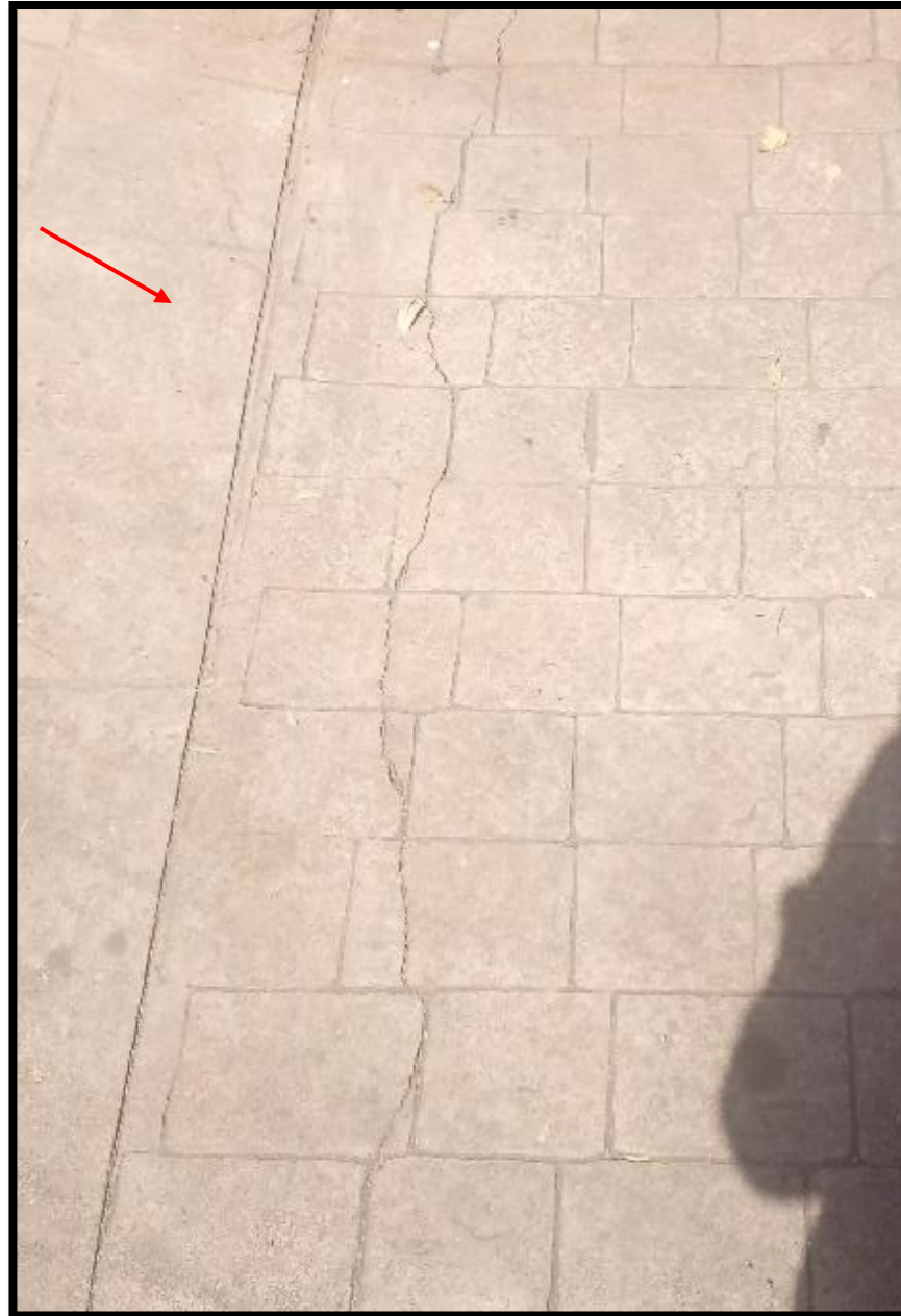
Coordenadas UTM Geográficas 14Q 480736.6987 19 ° 24 ' 14.05 " 2145556.349 -99 ° 11 ' 0.47 " Ubicación Calle Observatorio Ote. Escandón Observaciones Fractura en la banqueta
