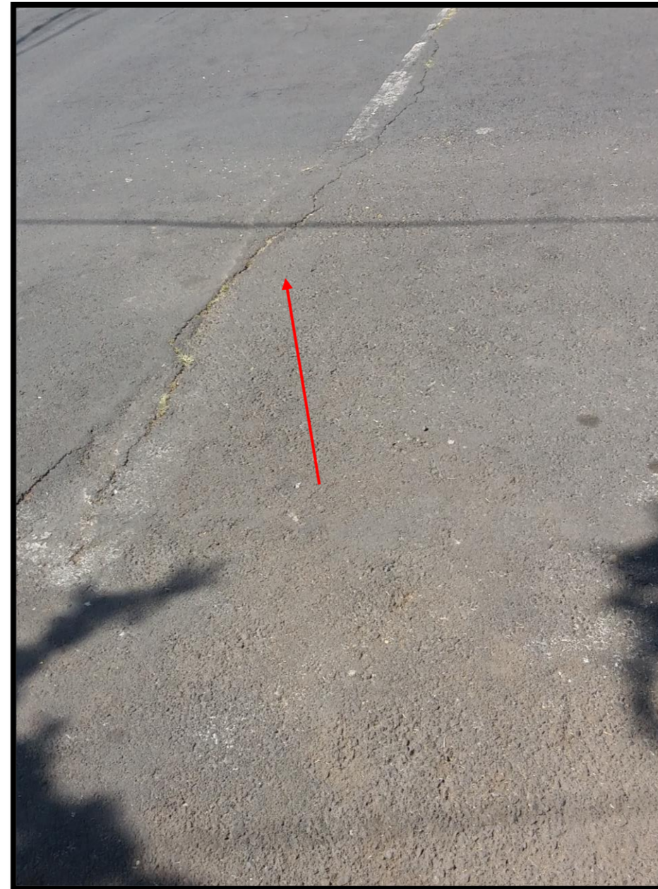
Coordenada UTM Geográfica 2151352.507 19°27'22.62"N 480761.8247 99° 9'59.82"O Ubicación Delegación Nueva Santa María Calzada de los Gallos 63, Plutarco Elías Calles, 11 Observación Agrietamiento sobre la calle
