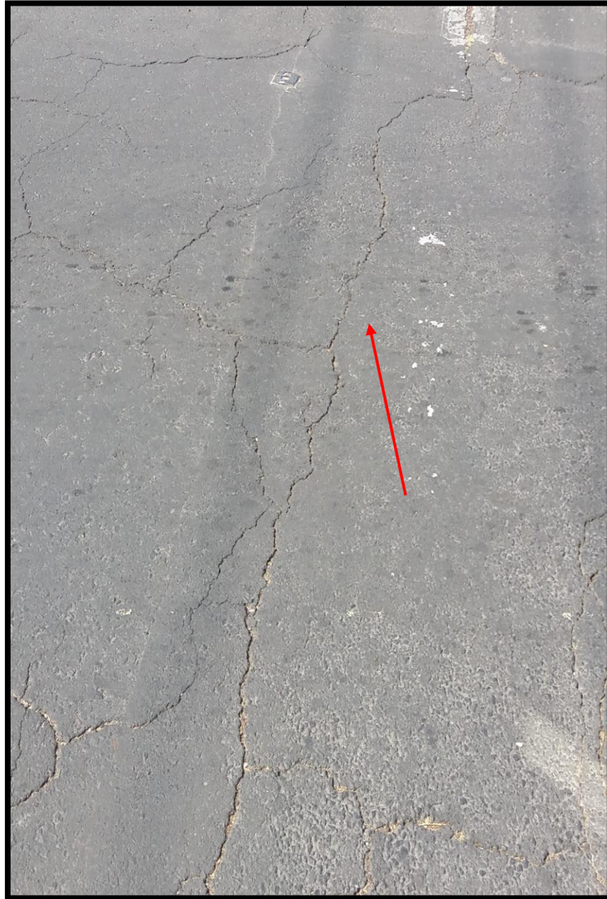
Coordenada UTM Geográfica 2151358.018 19°27'22.80"N 480781.9487 99° 9'59.13"O Ubicación Delegación Nueva Santa María Calzada de los Gallos 63, Plutarco Elías Calles, 11 Observación Agrietamiento sobre la calle
