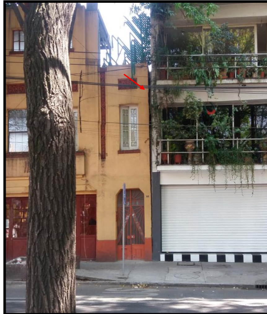
Coordenadas UTM Geográficas 14Q 481909 2146357 19 ° 24 ' 40.13738439 " -99 ° -10 ' -20.30353172 " Ubicación Av. Nuevo León, Hipódromo Observaciones Separación de edificios en la parte superior
