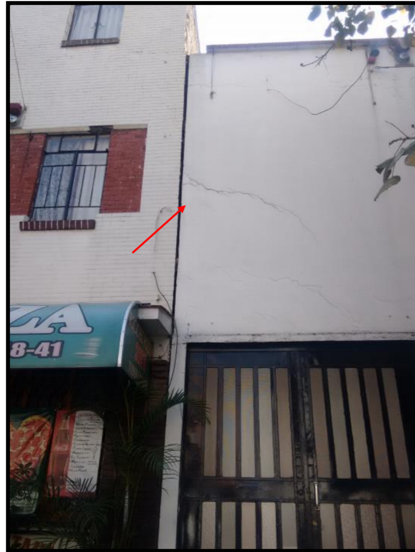
Coordenada UTM Geográfica 2145666.571 19°24'17.70"N 482687.1443 99° 9'53.60"O Ubicación Delegación Cuauhtémoc Roma Sur Observación Agrietamiento y junta estructural
