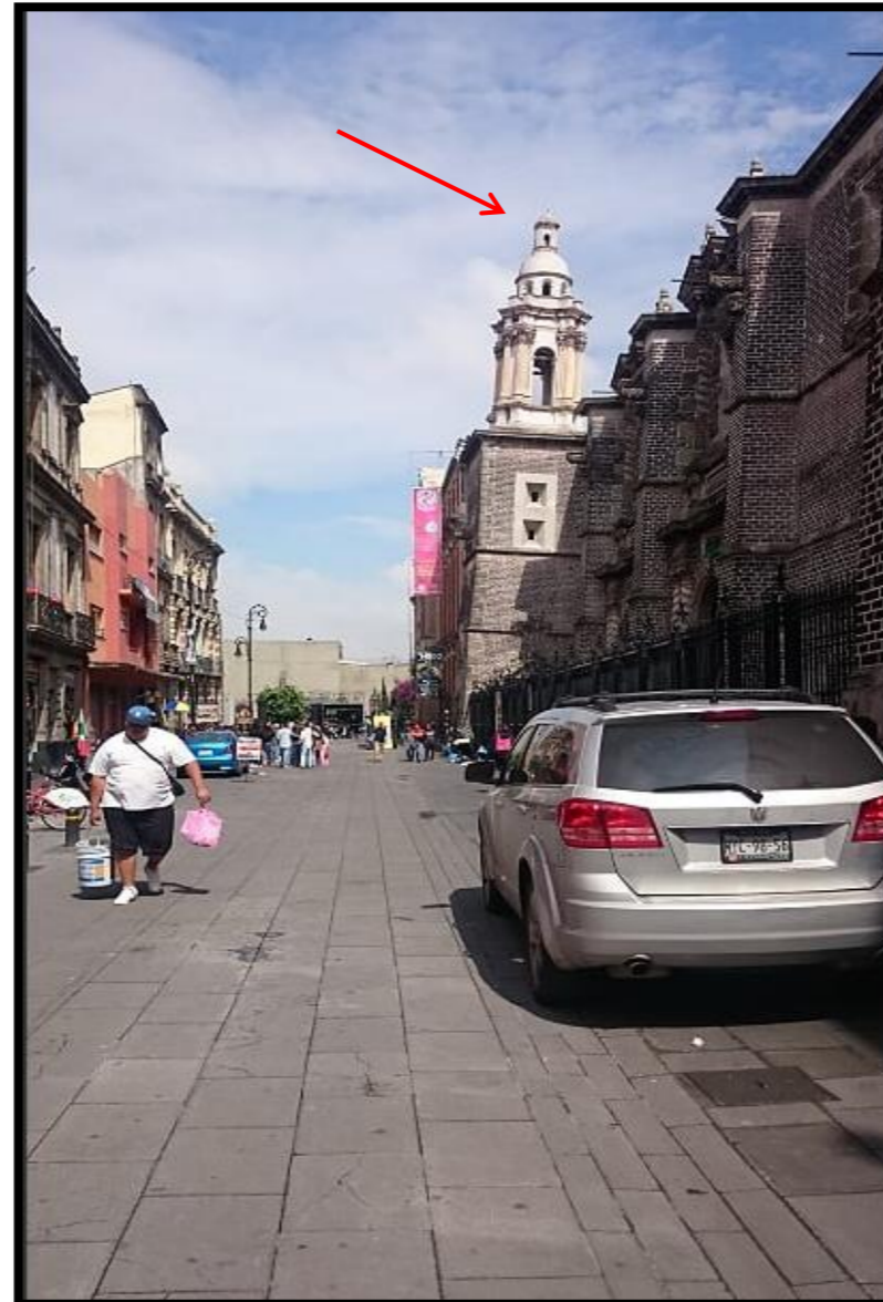
Coordenada UTM Geográfica 484710.9712 19°25'47.69"N 2148430.814 99°08'44.29"O Ubicación Delegación Cuauhtémoc, colonia Centro. Observación De lado derecho se observa el hundimiento del edificio.
