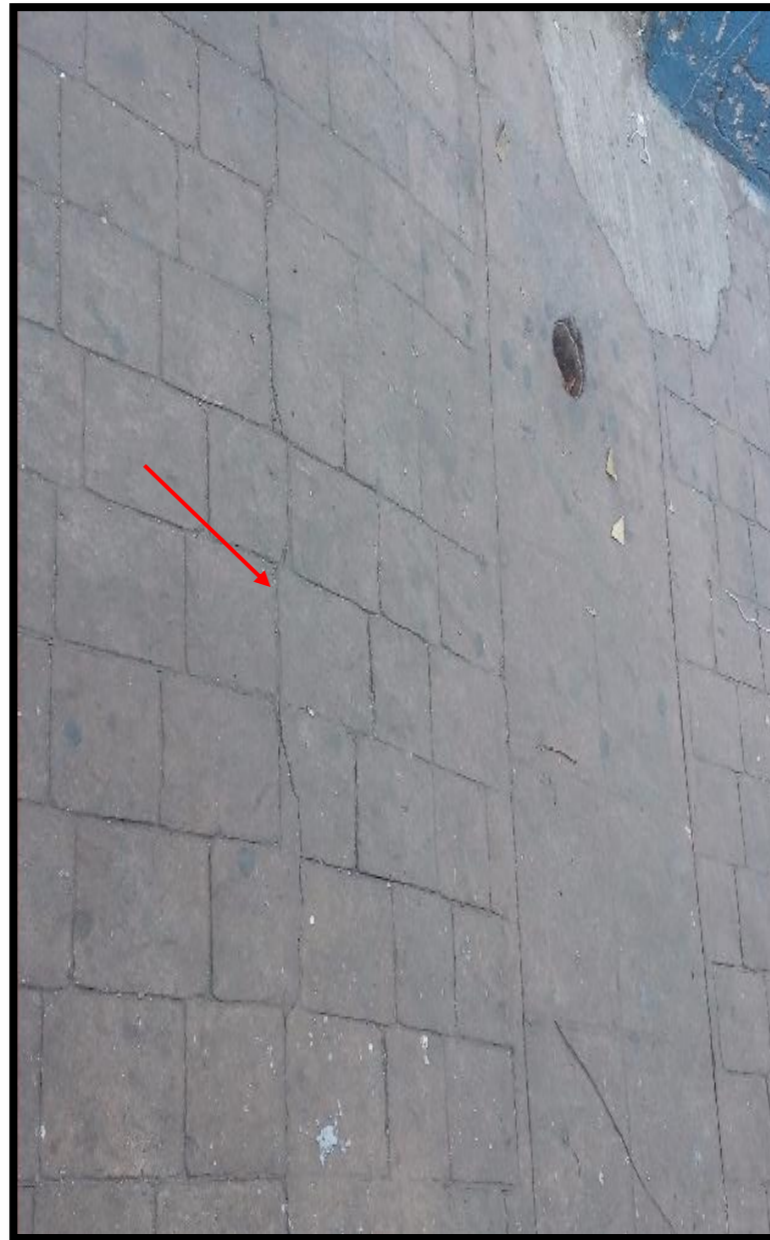
Coordenadas UTM Geográficas 14Q 481119.6981 19 ° 24 ' 6.45 " 2145322.341 -99 ° 10 ' 47.33 " Ubicación Calle José María Vigil, Escandón Observaciones Fracturas en la banqueta
