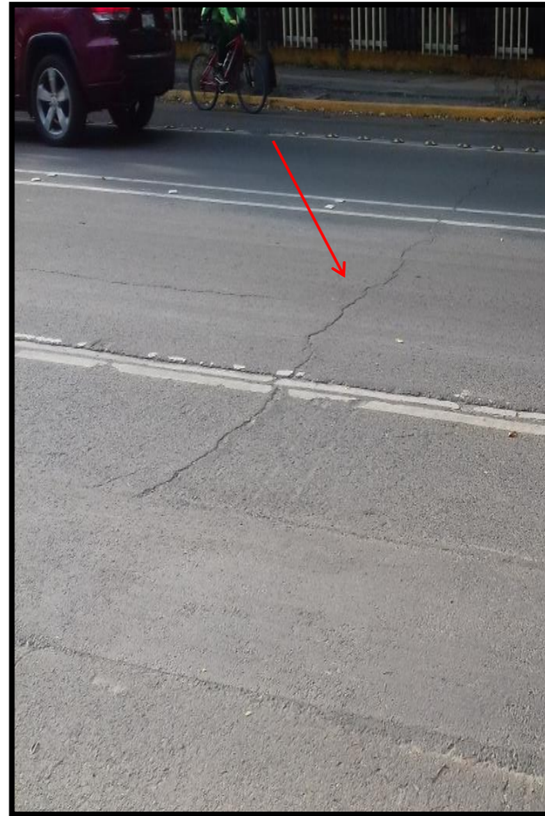
Coordenada UTM Geográfica 2149790.98 481105.4079 19°26'31.83"N 99°10'47.98"O Ubicación Delegación Miguel Hidalgo, Colonia Anáhuac. Observación Grieta en el terreno.
