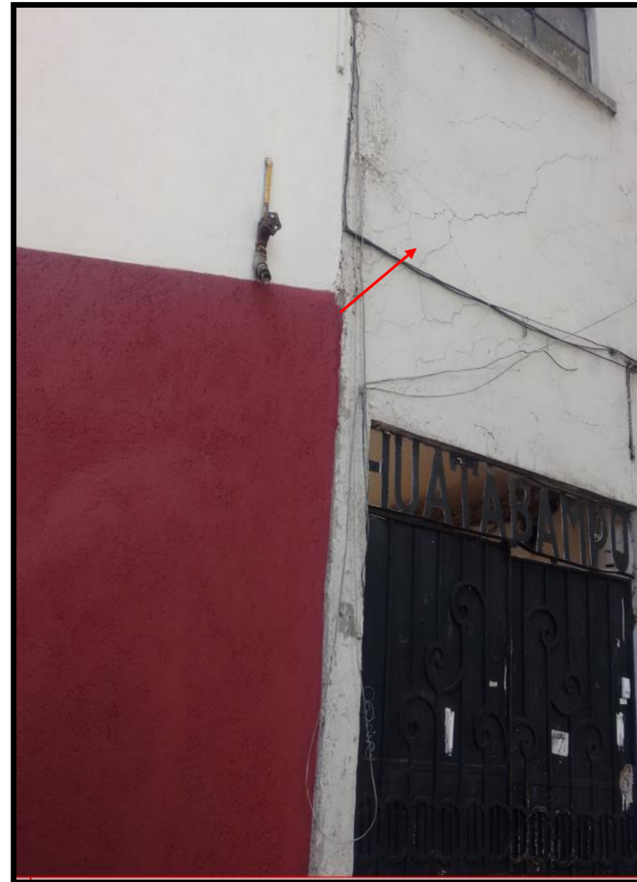
Coordenada UTM Geográfica 2145687.498 19°24'18.38"N 482660.3316 99° 9'54.52"O Ubicación Delegación Cuauhtémoc Colonia Roma Sur Observación Agrietamiento
