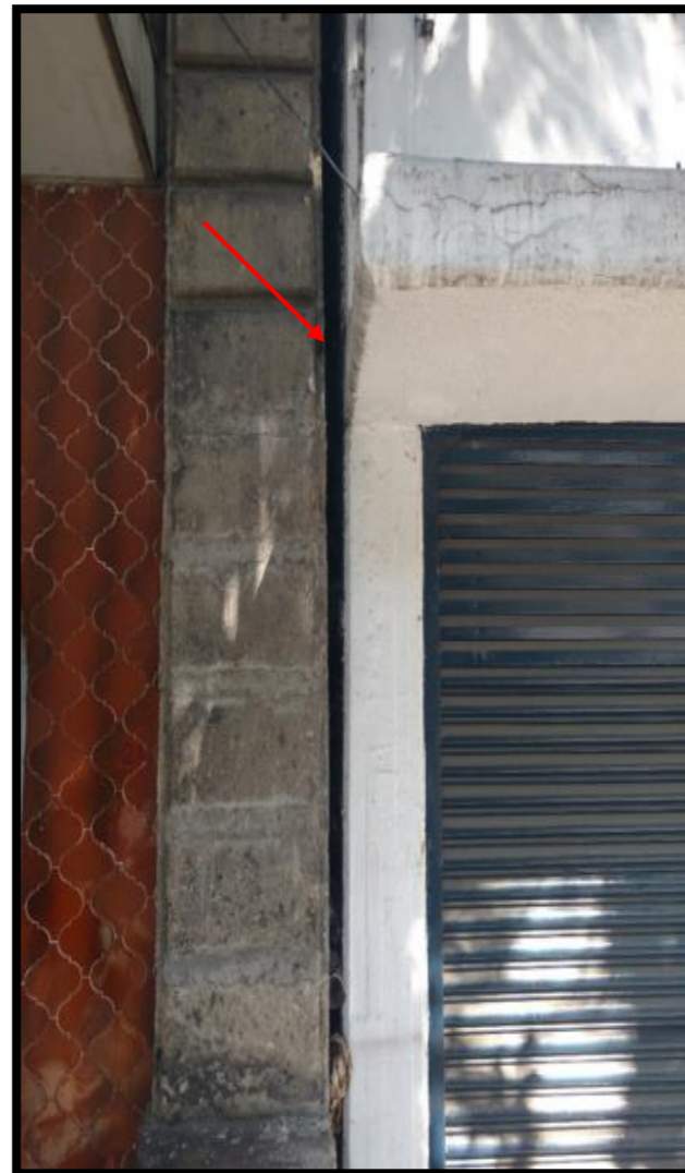
Coordenadas UTM 2148550.73 m N 484007.13 m E Geográficas N 19.431234° O 99.152348° Ubicación Calle Atenas. Col. Juárez Observación Separación diferencial por hundimiento.
