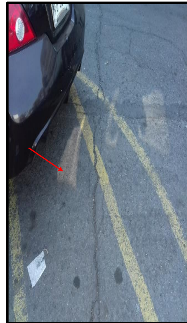
Coordenadas UTM 2180086.588 472099.7493 Geográficas 19°42'57.05''N 99°15'58.44''O Ubicación Chapultepec ,143 ,roma norte 06700 ciudad de México Observación Agrietamiento en la calle.
