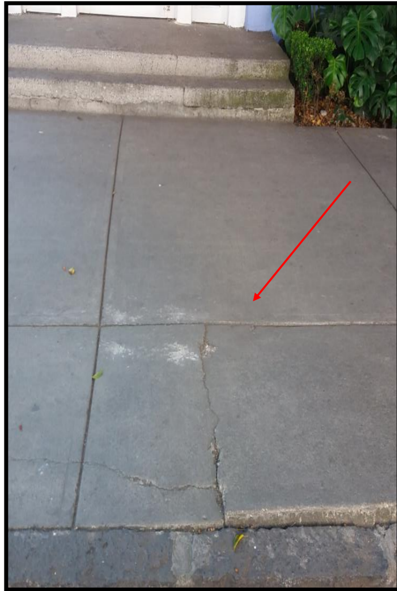
UTM Geográficas Coordenadas 14Q 482168.8759 2145973.526 19 ° 24 ' 27.67 " -99 ° 10 ' 11.38 " Ubicación Calle Aguascalientes, Hipódromo Observaciones Fractura en la baqueta
