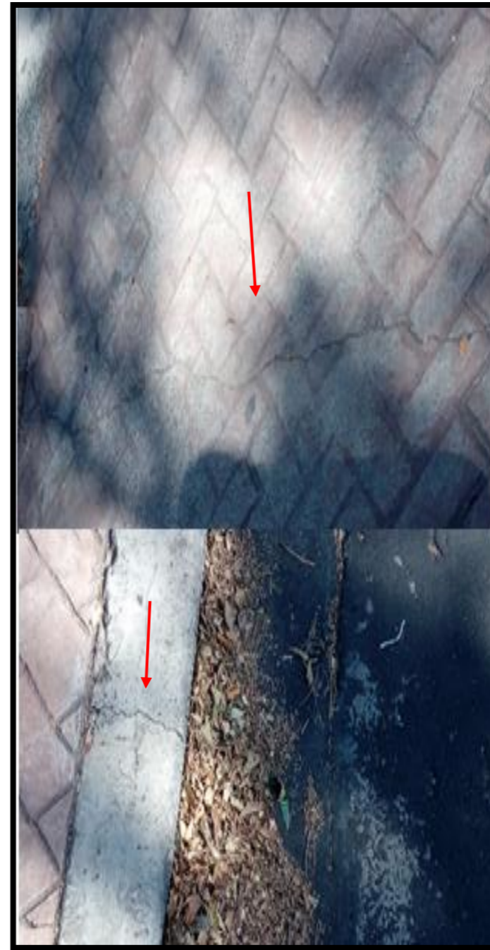
Coordenadas UTM Geográficas 14Q 481847.1232 19 ° 26 ' 57.01 " 2150564.192 - 99 ° 10 ' 22.57 " Ubicación Calle Felipe Carrillo Puerto, Popotla Observaciones Fractura desde el asfalto hasta la banqueta
