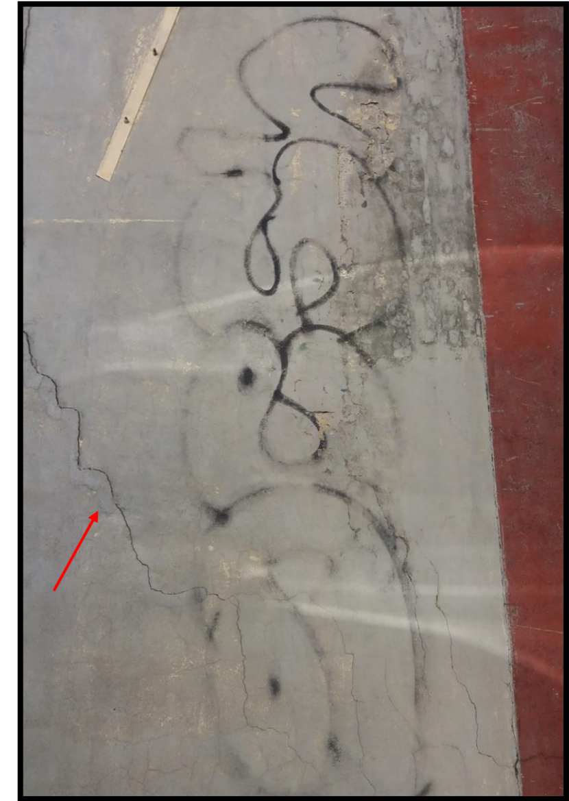
Coordenada UTM Geográfica 2151374.276 19°27'23.38"N 482318.236 99°10'6.44"O Ubicación Delegación Nueva Santa María Calzada de los Gallos 63, Plutarco Elías Calles, 11 Observación Agrietamiento sobre una casa
