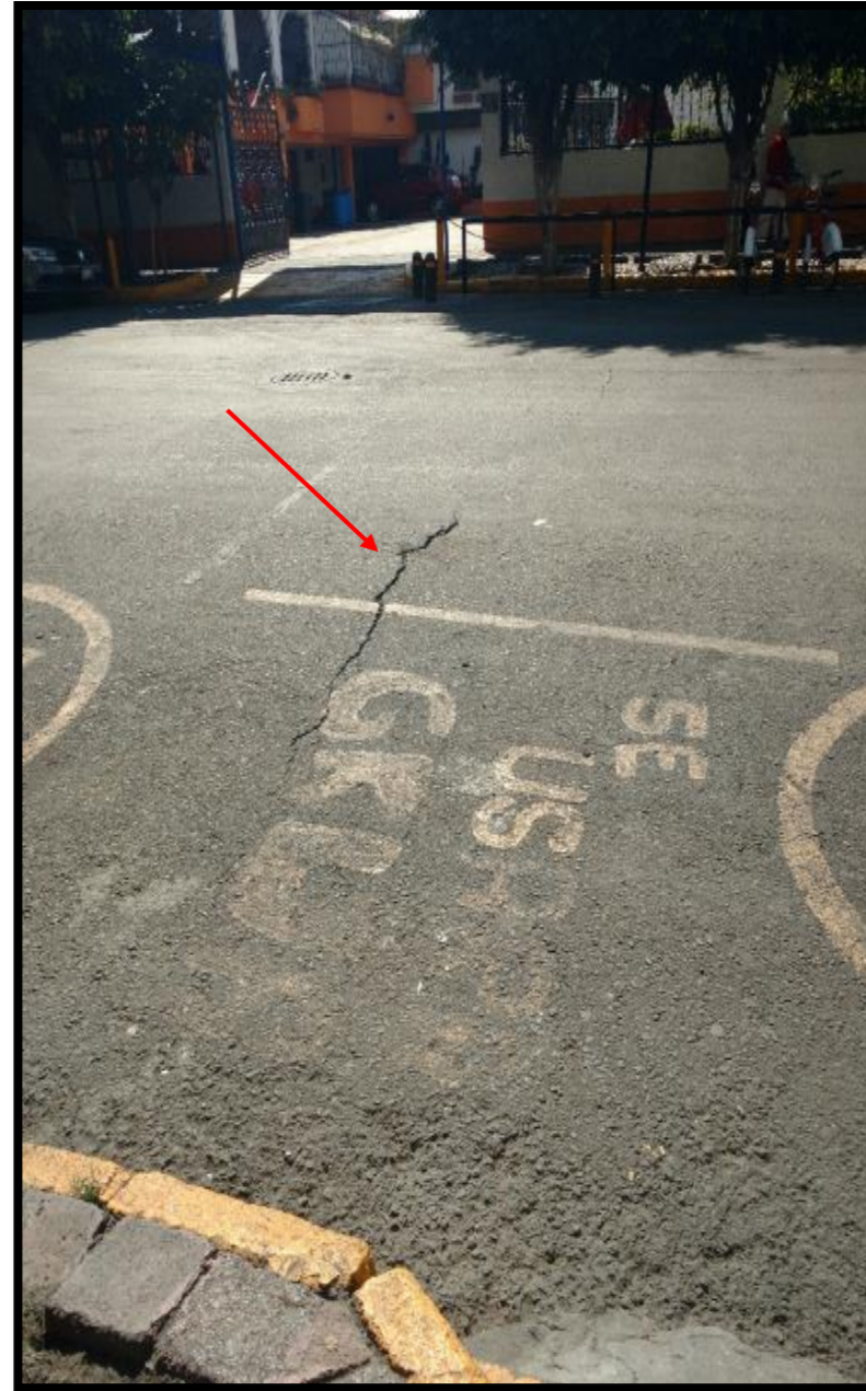
Coordenadas UTM 2148313.49 m N 483885.36 m E Geográficas N 19.429089° O 99.153506° Ubicación Calle Lucerna. Col. Juárez Observación Agrietamiento
