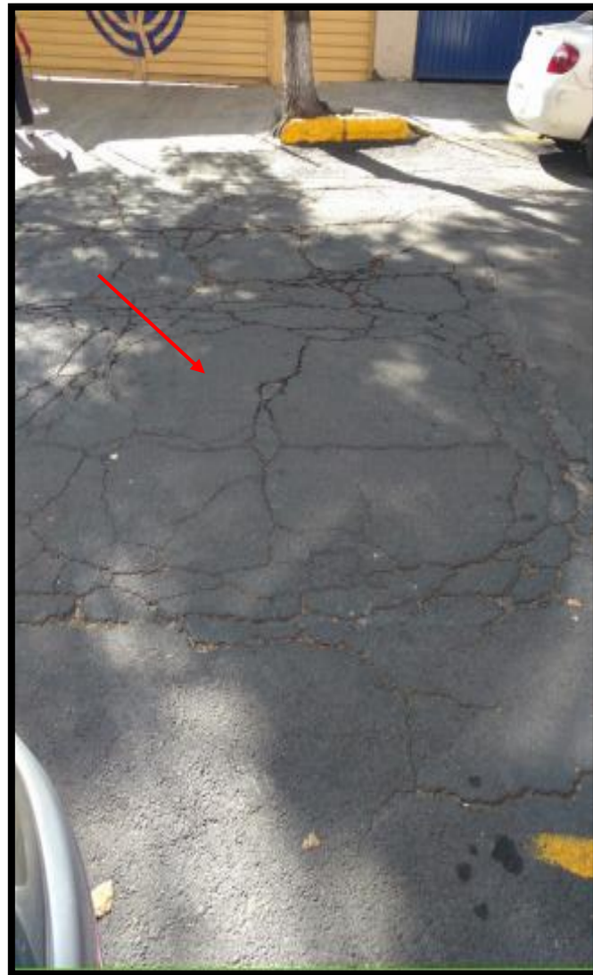
Coordenadas UTM 2146100.84 m N 479532.90 m E Geográficas N 19.409053° O 99.194943° Ubicación Calle. General José Morán. Col. Daniel Garza Observación Agrietamiento
