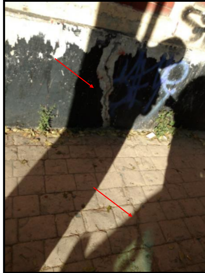
UTM Geográficas Coordenadas 2146155.67 m N 479774.33 m E N 19.409551° O 99.192644° Ubicación Calle. Gral. F. Ramírez. Col. Daniel Garza Observación Agrietamiento
