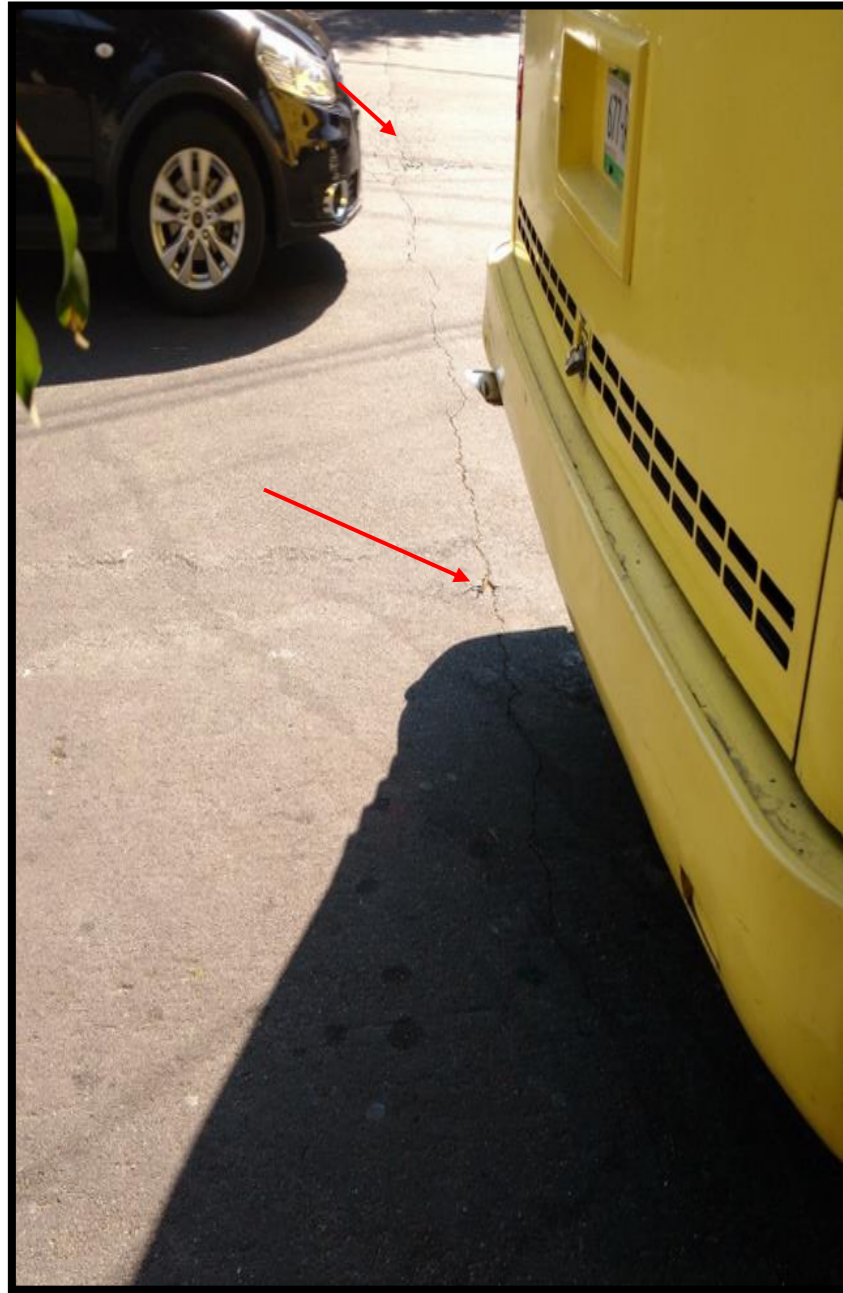
Coordenadas UTM Geográficas 2145288.64 m N N 19.401708° 479055.40 m E O 99.199482° Ubicación Calle. Sostenes Rocha. Col. Cove Observación Agrietamiento
