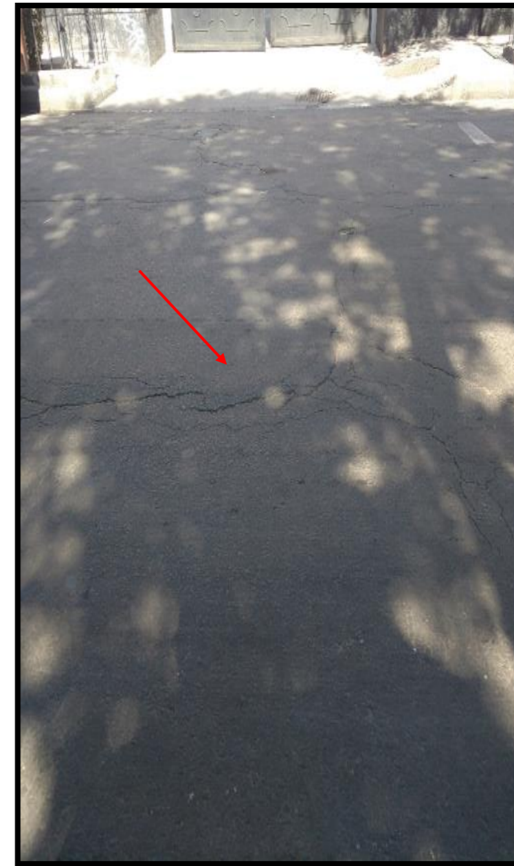
Coordenadas UTM 2148392.26 m N 483661.20 m E Geográficas N 19.429799° O 99.155642° Ubicación Calle Lucerna. Col. Juárez Observación Agrietamiento
