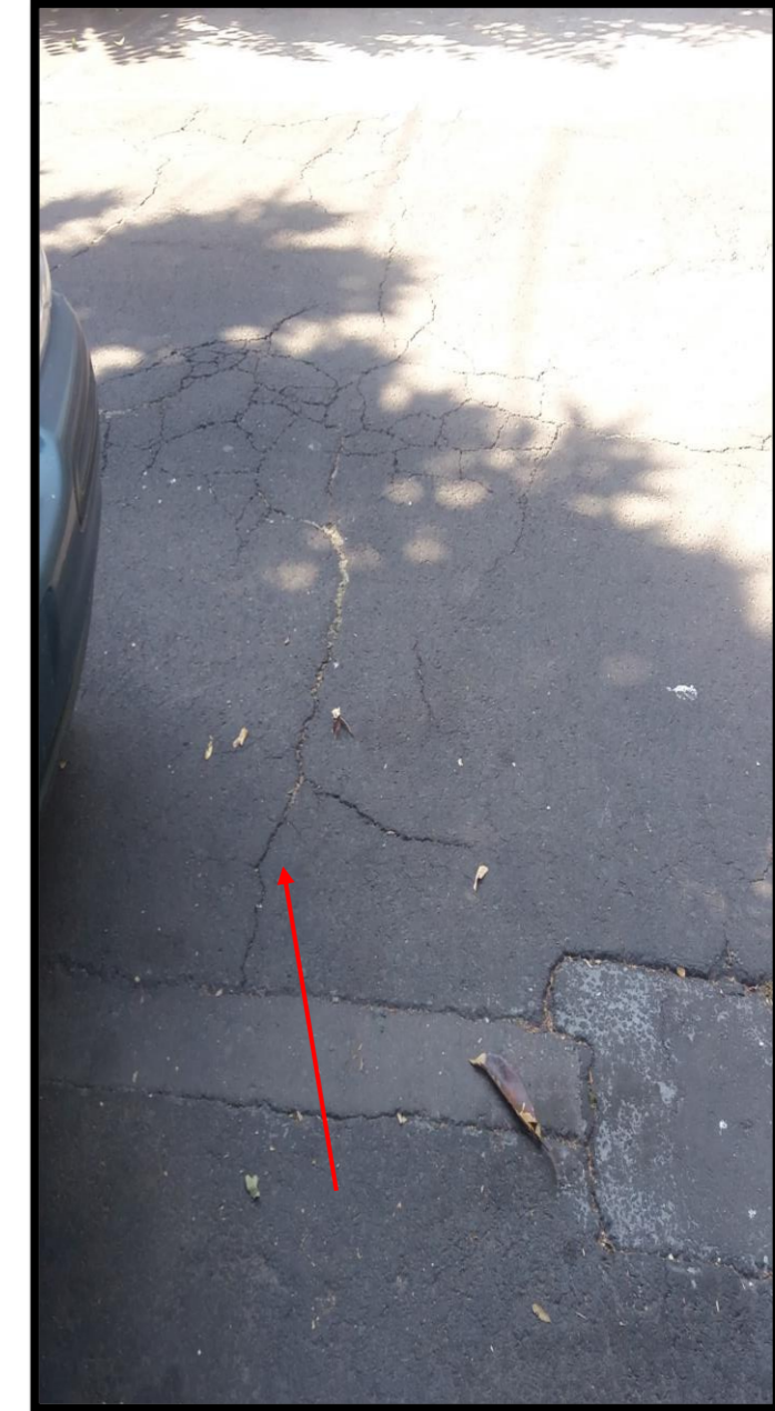
Coordenada UTM Geográfica 2151346.317 19°27'22.42"N 480801.4713 99° 9'58.46"O Ubicación Delegación Nueva Santa María Calzada de los Gallos 63, Plutarco Elías Calles, 11 Observación Agrietamiento sobre la calle
