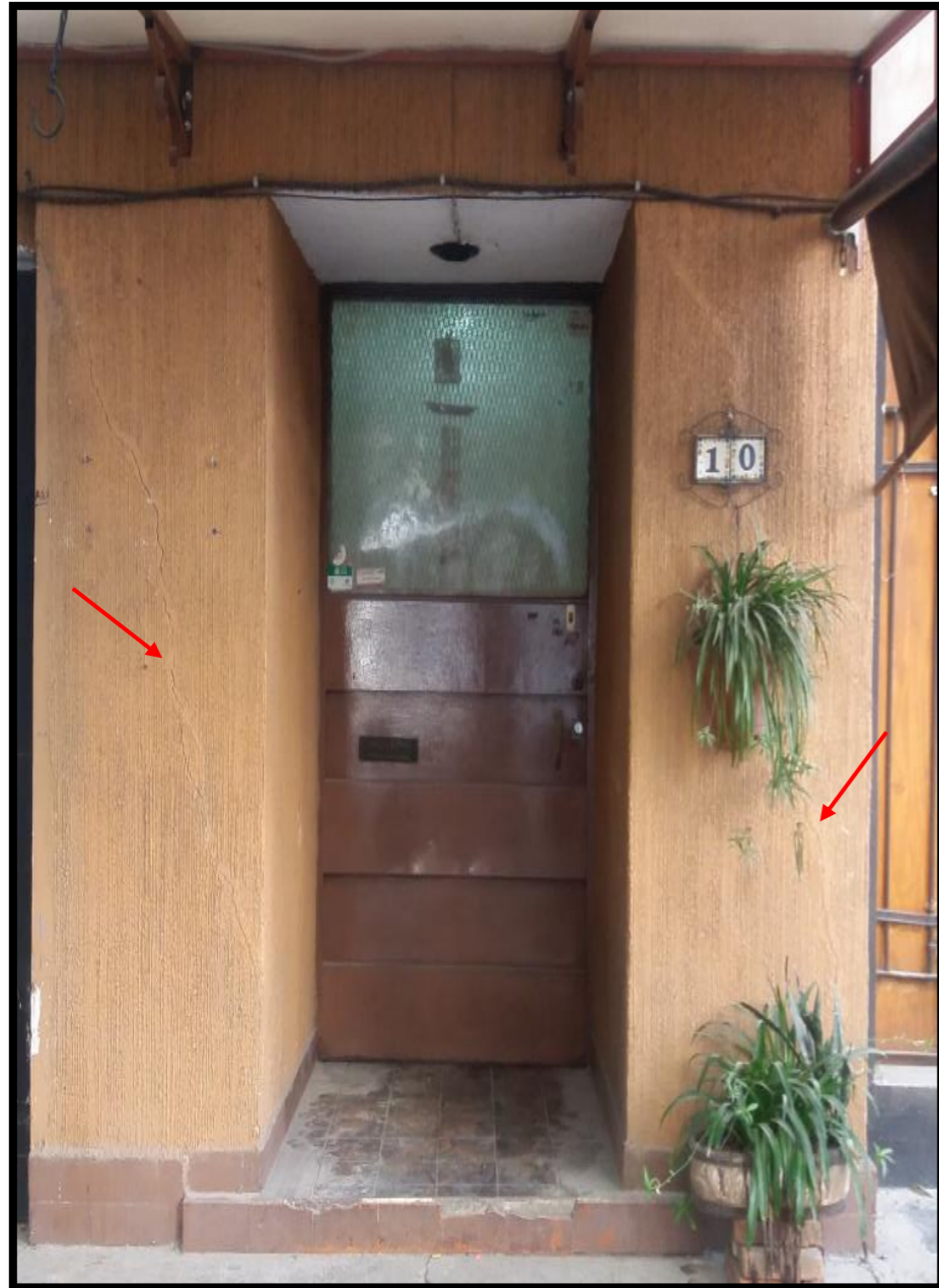
UTM Geográficas Coordenadas 14Q 482299.44 2146694.98 19 ° 24 ' 51.14563507 " -99 ° -10 ' -6.927516731 " Ubicación Calle México, Hipódromo Observaciones Fracturas a las orillas de la construcción
