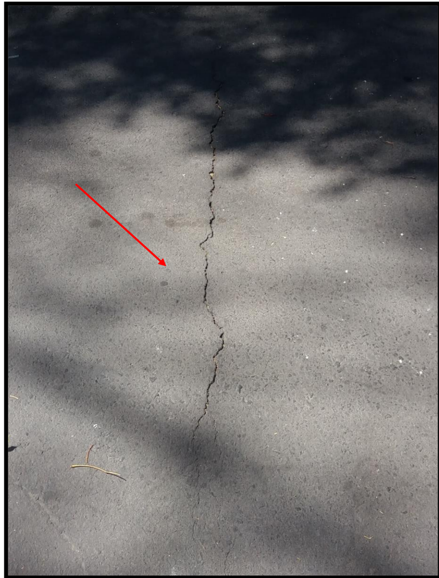
Coordenada UTM Geográfica 2151396.984 19°27'24.12"N 482356.7451 99°10'5.12"O Ubicación Delegación Nueva Santa María Calzada de los Gallos 63, Plutarco Elías Calles, 11 Observación Agrietamiento sobre la calle
