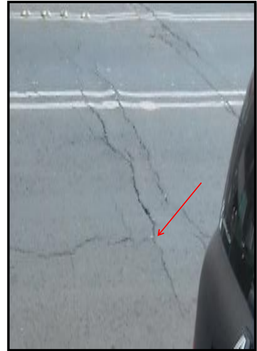
Coordenada UTM Geográfica 2149733.808 481105.3481 19°26'29.97"N 99°10'47.98"O Ubicación Delegación Miguel Hidalgo, Colonia Anáhuac. Observación Grieta en el terreno.
