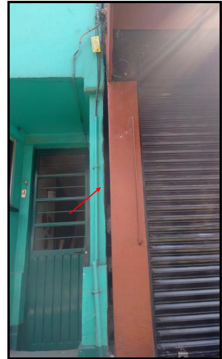
Coordenada UTM Geográfica 2145668.746 19°24'17.77"N 482662.9386 99° 9'54.43"O Ubicación Delegación Cuauhtémoc Colonia Roma Sur Observación Agrietamiento y junta estructural
