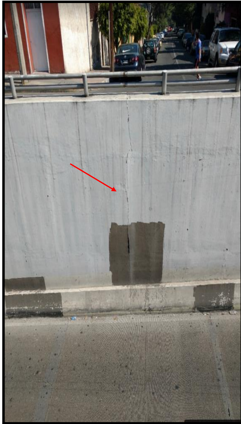
Coordenadas UTM 2145826.68 m N 478916.70 m E Geográficas N 19.406569° O 99.200809° Ubicación Av. Camino de los Toros. Col. América Observación Agrietamiento
