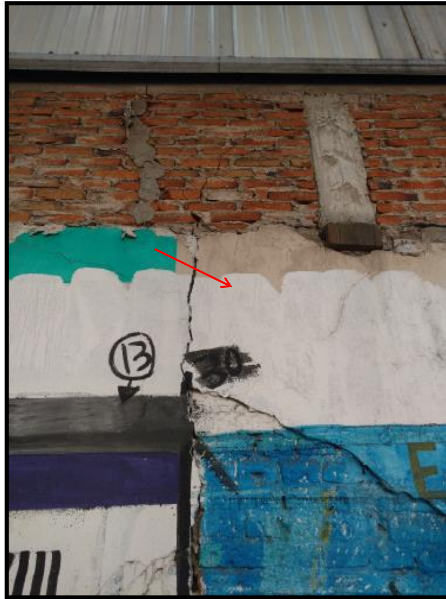
Coordenada UTM Geográfica 2149931.766 19°44'36.96"N 518180.4425 99°17'32.00"O Ubicación Col. Anáhuac Sec.1 Observación Agrietamiento en la pared del de edificio que se extiende a lo largo de este.
