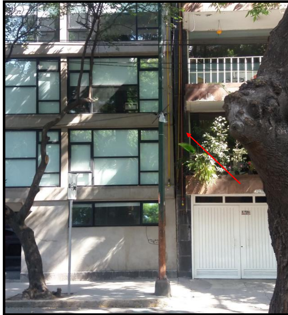
Coordenadas UTM Geográficas 14Q 481863 2146181 19 ° 24 ' 34.40998026 " -99 ° -10 ' -21.87472618 " Ubicación Av. Nuevo León, Hipódromo Observaciones Separación de edificios en la parte superior*
