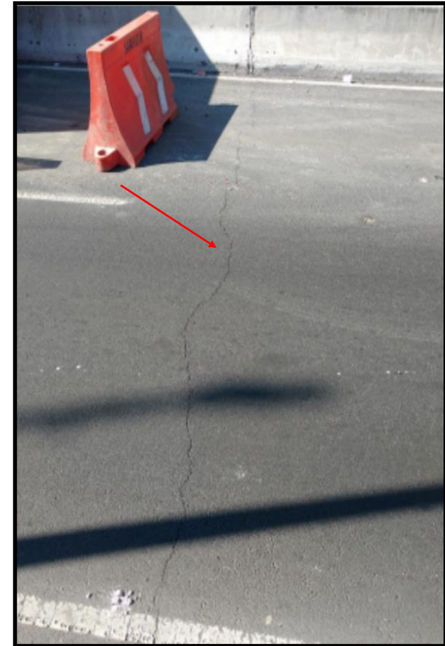
Coordenadas UTM Geográficas 2145128.18 m N N 19.400255° 478776.77 m E O 99.202134° Ubicación Calle Sur 128. Col. Las Américas Observación Agrietamiento
