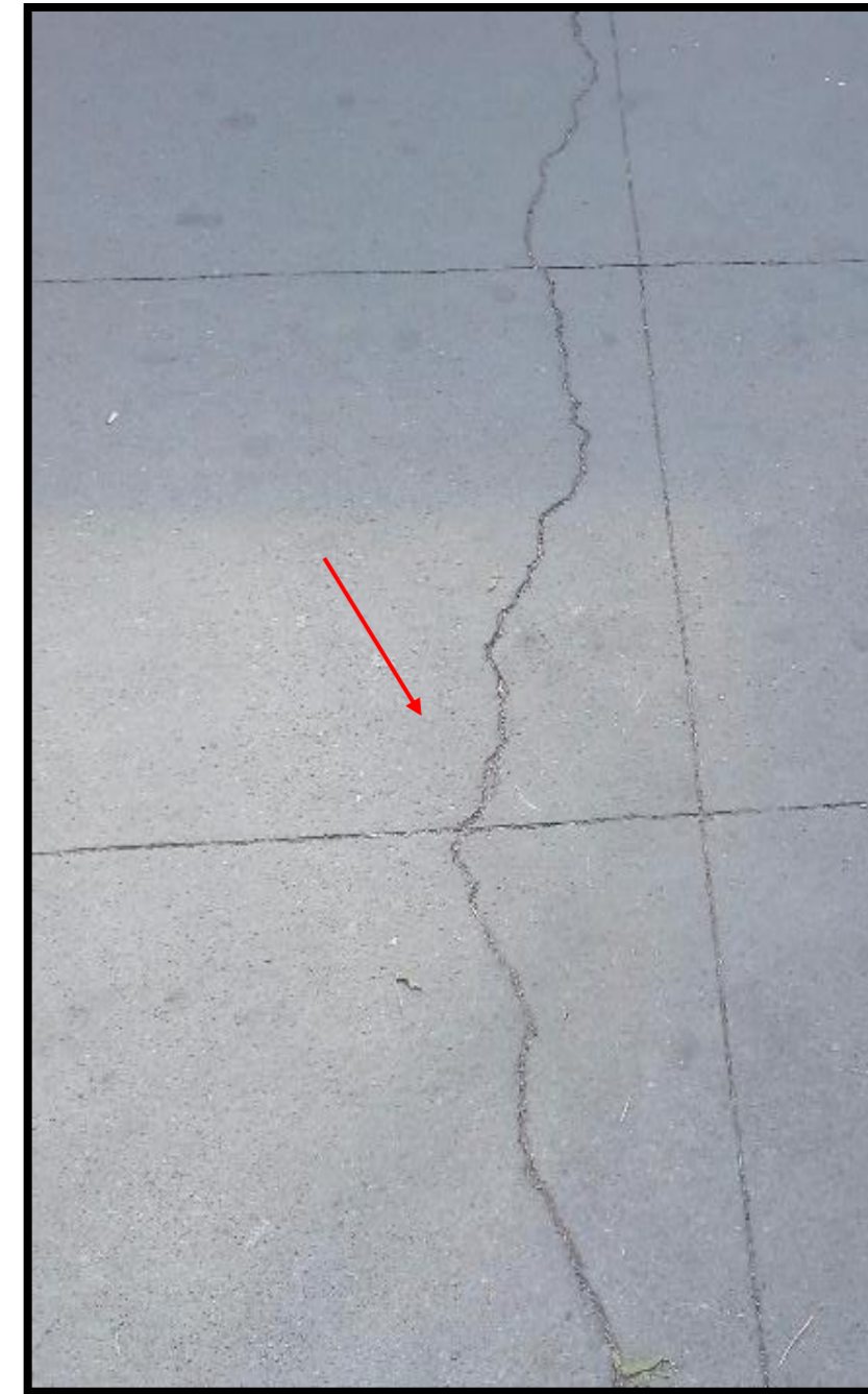
Coordenadas UTM Geográficas 14Q 481619.1971 19 ° 27 ' 9.2 " 2150939.115 -99 ° 10 ' 30.4 " Ubicación Calle México Tacuba, Popotla Observaciones Fractura en la banqueta
