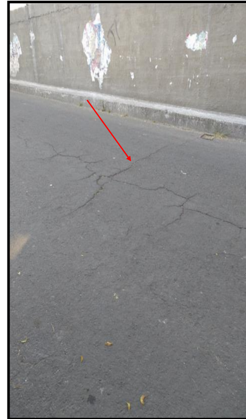
Coordenadas UTM Geográficas 2145045.09 m N N 19.399518° 480137.85 m E O 99.189170° Ubicación Av. Rio de Tacubaya. Col. Tacubaya Observación Agrietamiento
